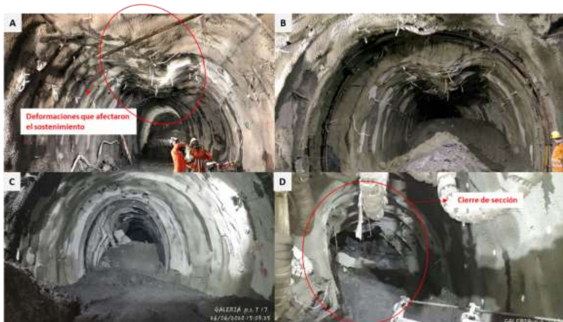
Ilustración 6.3. Perdida de sección en la galería de escape luego de instalar el sostenimiento final, con el avance bastantes metros más adelante. A) deformaciones, flexiones de arcos y pernos iniciales de forma progresiva. B) Cierre progresivo de sección con rotura de arcos. C) Cierre de sección acompañado de derrubios de material. D) Colapso y cierre final de la sección. Lo anterior en el transcurso de un mes y medio. Tomado y modificado de: (INTEGRAL S.A, 2022).
