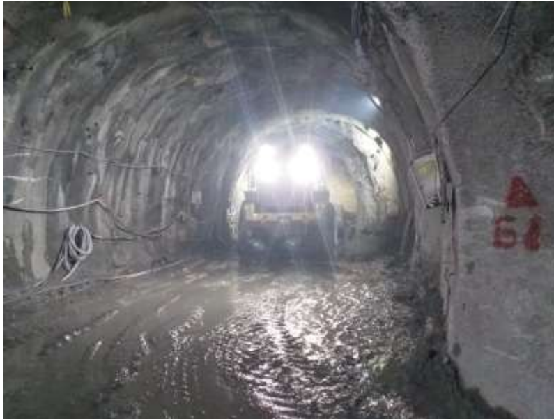
Ilustración 18.6. Infiltraciones constantes desde los frentes de excavación que inunda en ocasiones el frente de avance. Tomado y modificado de: (INTEGRAL S.A, 2022).
