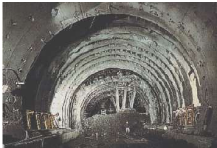
Ilustración 19.6. Túnel de Stefano (Italia, línea de ferrocarril Génova - Ventimiglia: calizomargosa tectonizada y laminada, cobertura: 150 m, diámetro 12 m). Colapso de la cavidad. Tomado de: Lunardi, (2004).
