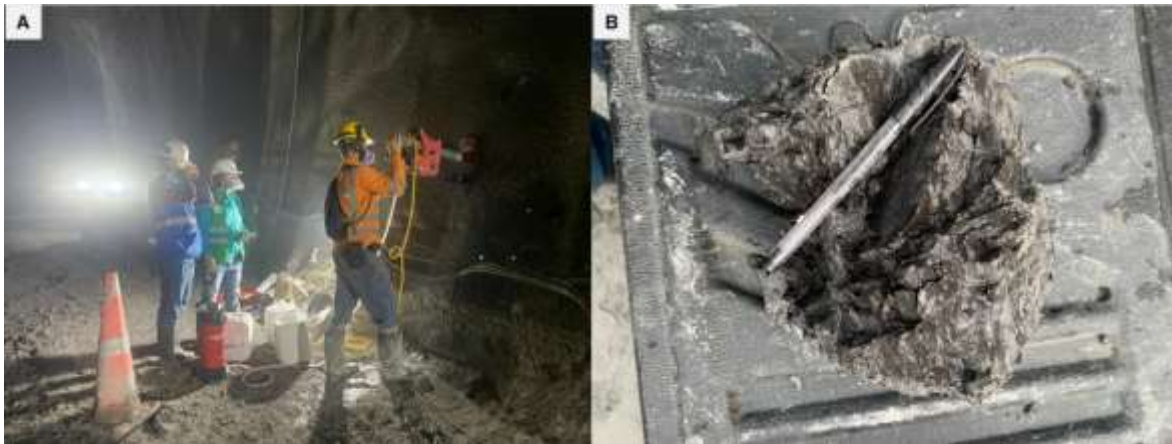
Ilustración 16.1. Portal Cañasgordas. A) Extracción de núcleos con barreno mecánico. B) Bloque de lodolitas tomado del hastial izquierdo.
