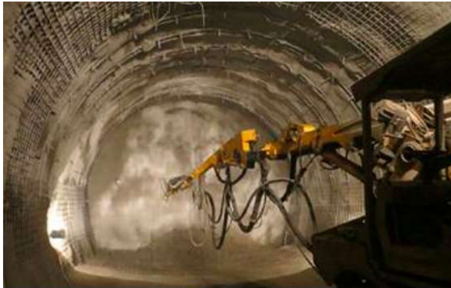
Ilustración 21.3. Sellado de frente de ejemplo con hormigón proyectado. Tomado de: Celada, Adasme, & González, (2015).
