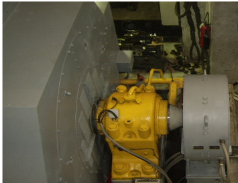
Ilustración 16. Cojinetes radiales en el eje del generador.
