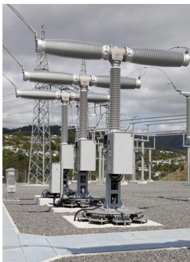
Fig 1. Interruptor aislado sísmicamente mediante el sistema Wire Rope.
