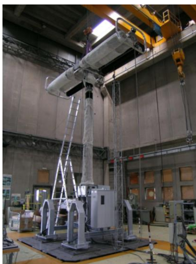
Fig 2. Interruptor aislado sísmicamente mediante el sistema péndulo de fricción.
