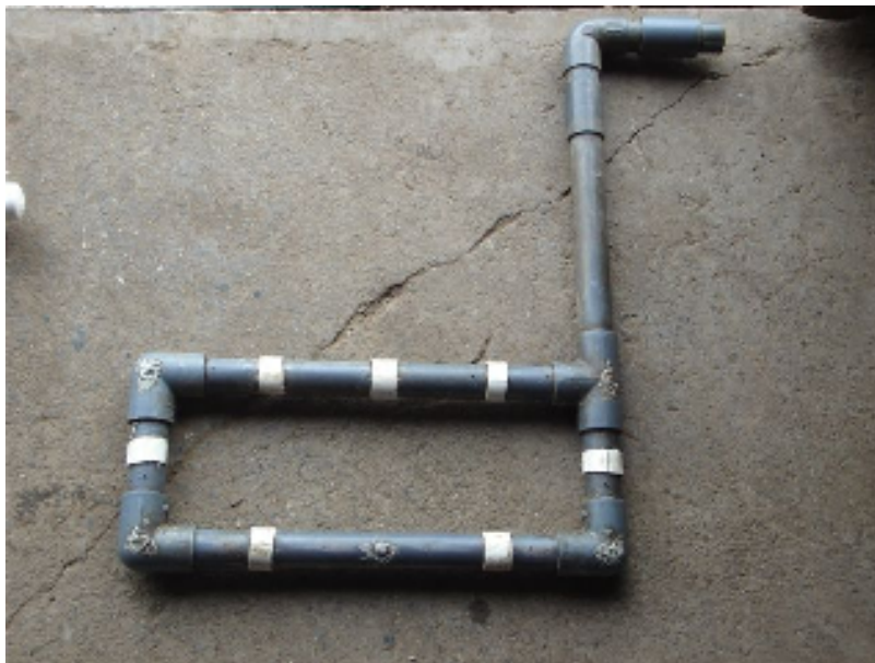
Figura 18 Sistema de aspersión ineficiente.
