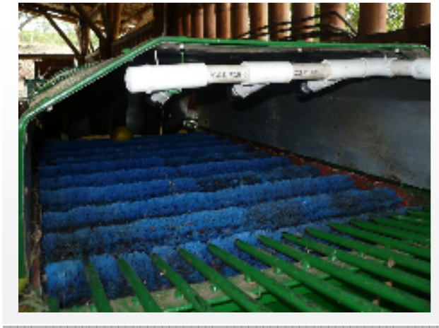
Figura 31 Sistema aspersión instalado
