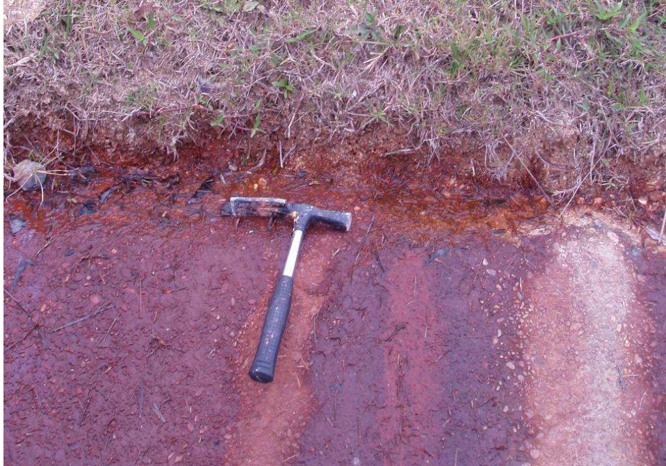
Figura 17. Obsérvese como el hierro movilizado tiñe el pavimento de la vía construída en 1995, adyacente a la estación FSN 14 (Valle de San Nicolás), foto tomada en octubre 2006
