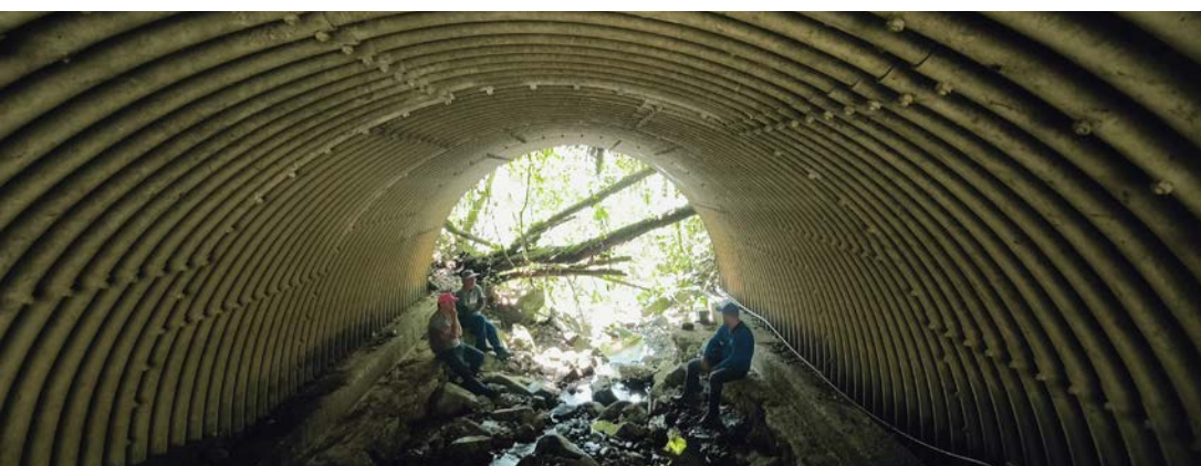
FIGURA 55: Infraestructura para paso de vehículos por la parte superior y quebrada por debajo.
