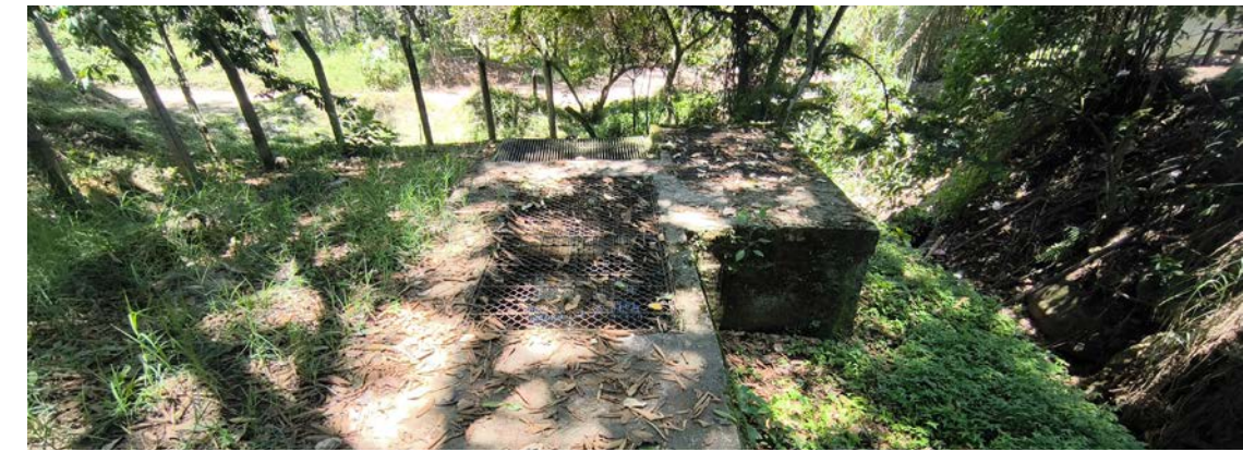
FIGURA 57: Zona de Bocatomas parte media de la cuenca. Infraestructura con potencial de uso.
