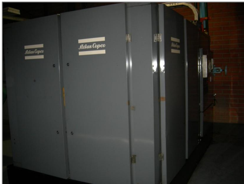
Fotografía 2. Compresor Atlas Copco ZR5 - SOFASA
