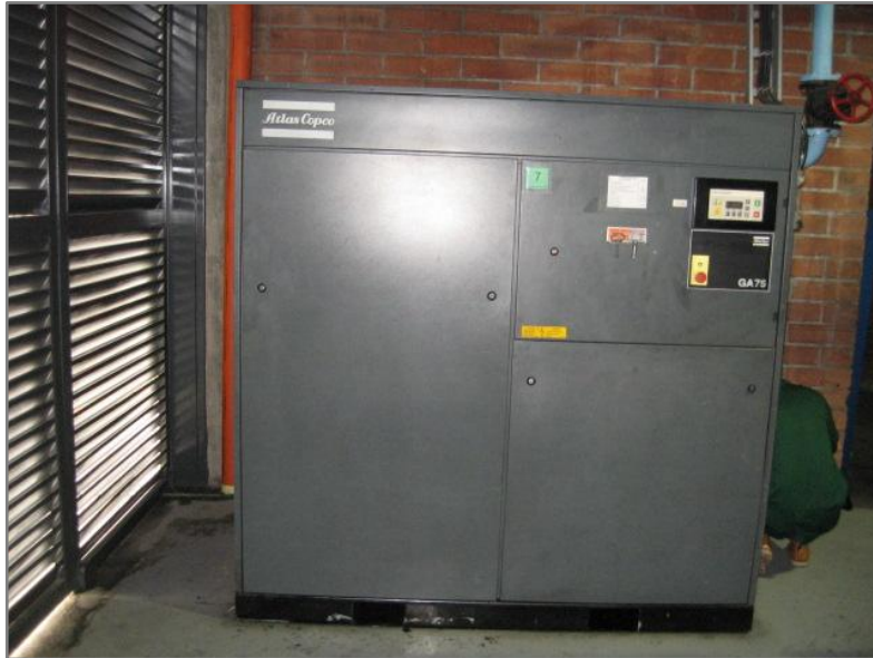
Fotografía 1. Compresor Atlas Copco GA75 - SOFASA
