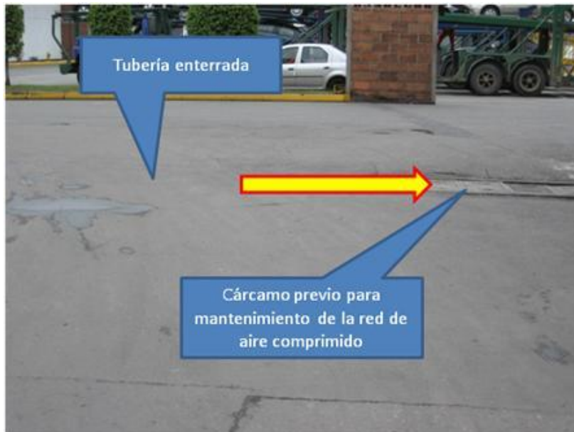
Fotografía 8. Tramo enterrado sin posibilidad de mantenimiento.
