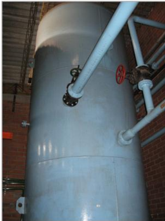
Fotografía 4. Tanque Pulmón Principal red de aire comprimido SOFASA
