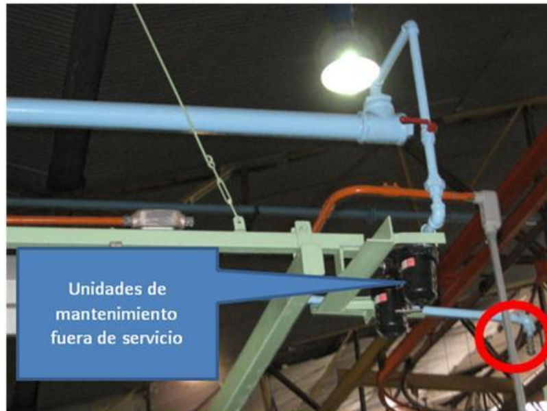
Fotografía 11. Unidades de mantenimiento fuera de servicio.
