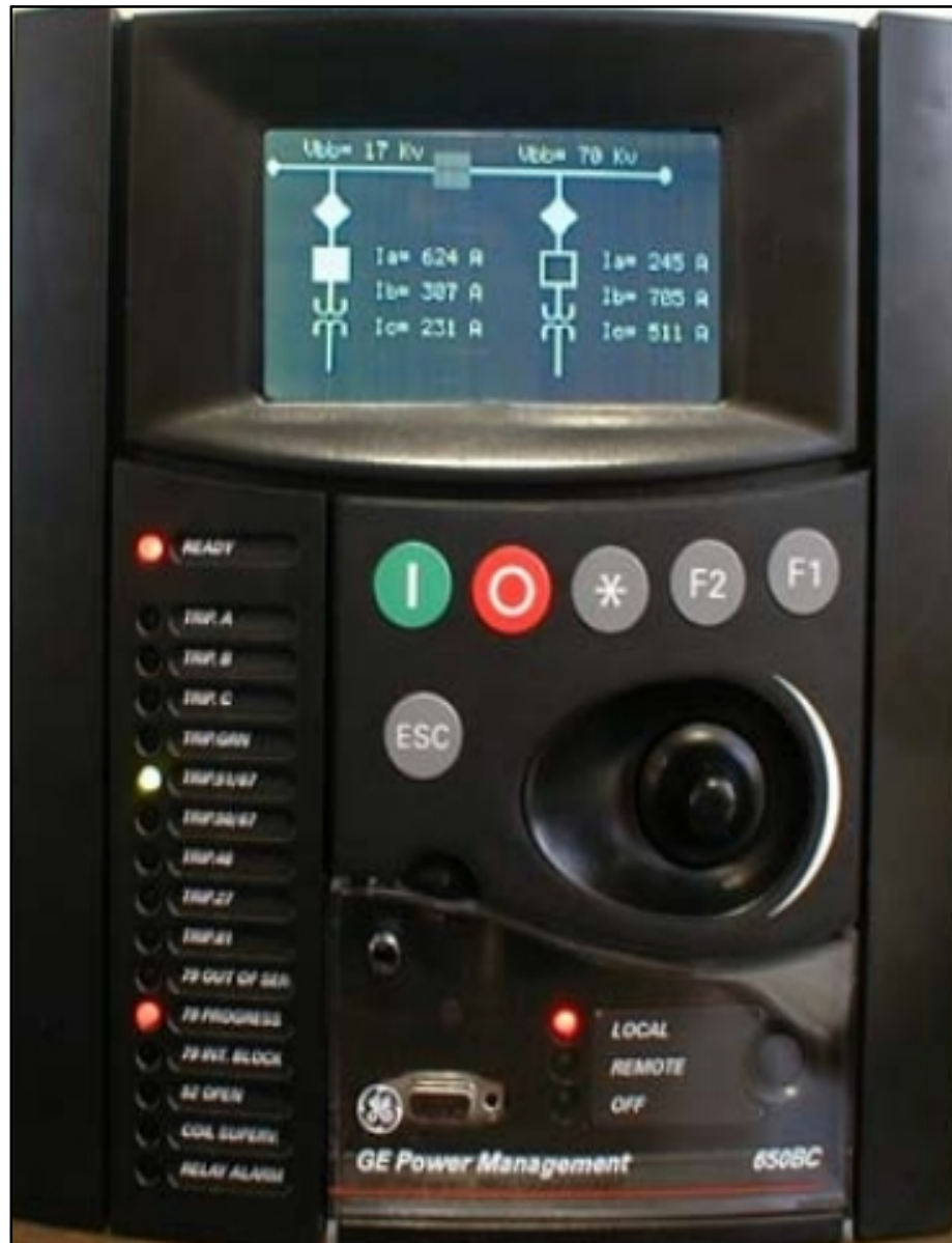
Ilustración 40 - Control Multilin del Motor
