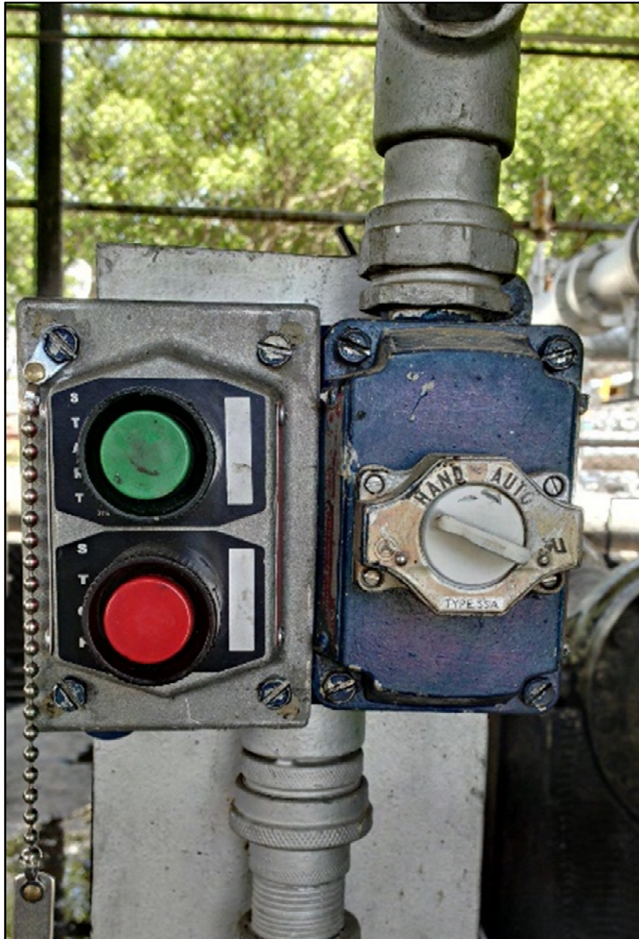
Ilustración 39 - Interruptor de encendido y Mando Automático-Manual
