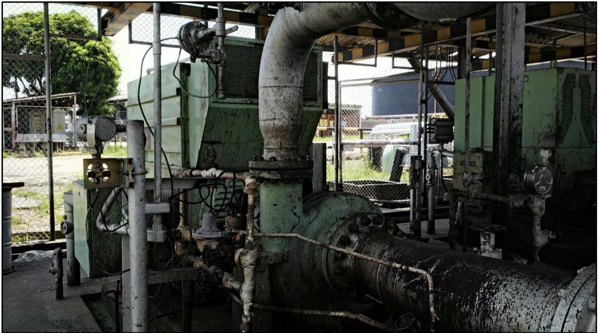
Ilustración 24 - Casa de Bombas
