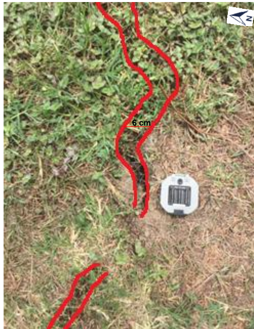
Figura 38 Punto de Interés 1 Grietas
