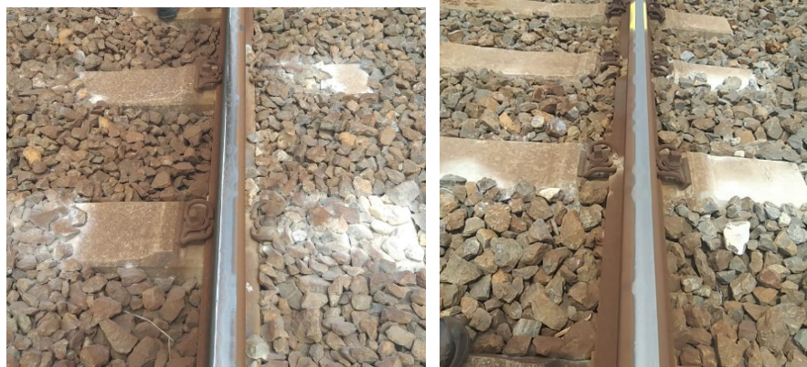
Figura 3. Presencia de polvo blanco sobre durmientes en la vía comercial.
