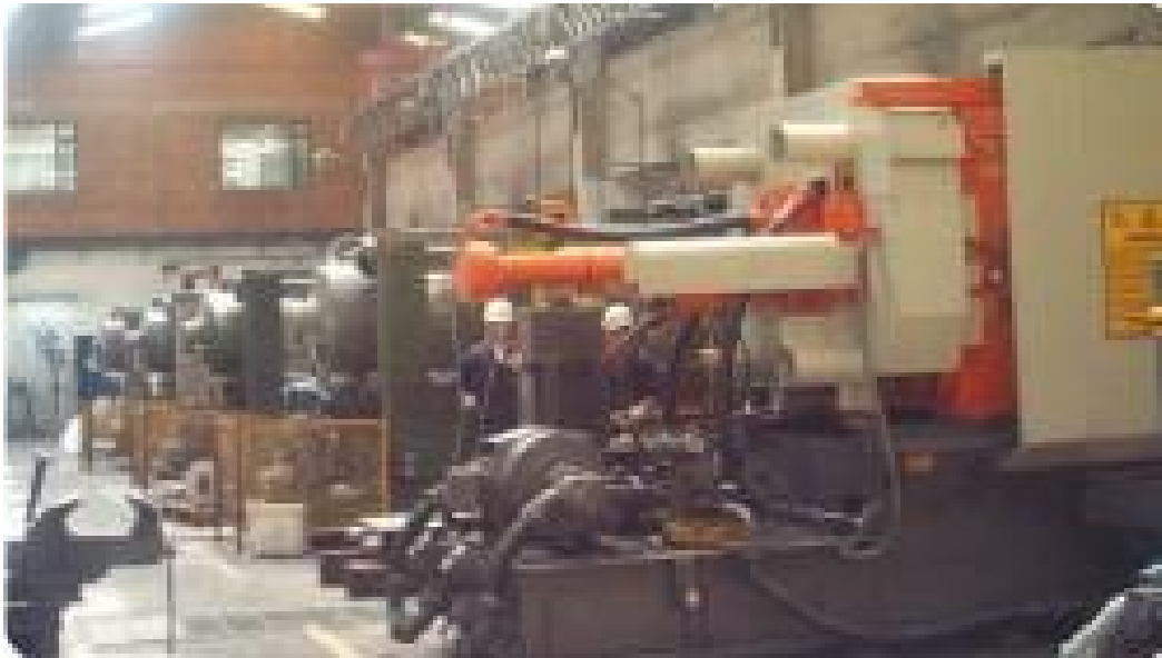
Imagen 5. Equipos de inyección de la década 2000.
