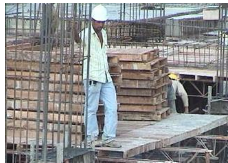
Figura 13: Falta de seguridad en alturas
