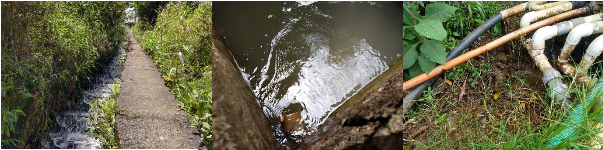
Figura 7-17 Captación de agua para el acueducto comunitario del Barrio Bello Oriente
