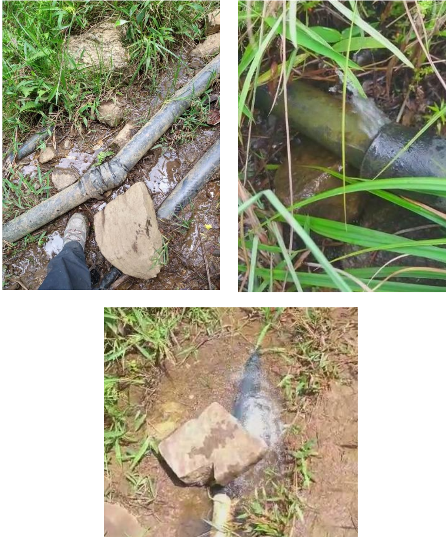
Figura 7-20. Fugas en las mangueras del acueducto comunitario verificadas en campo en octubre 2020
