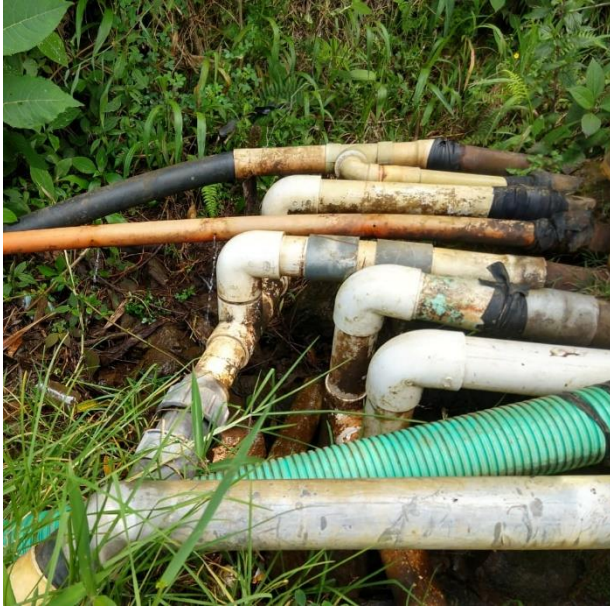
Figura 7-7. Fotografía captación de agua en el rebose del tanque El Toldo
