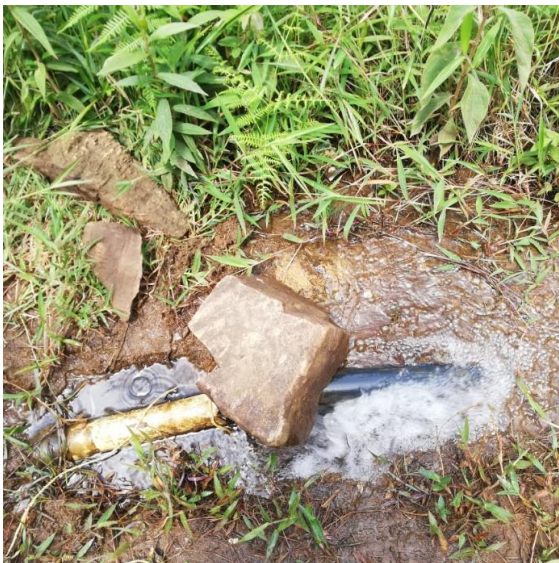
Figura 7-10. Fotografía fugas de agua
