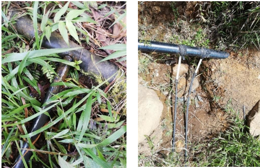
Figura 6-12. Conexiones individuales a la manguera principal de manera inapropiada.
