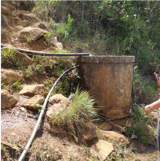
Figura 7-8. Fotografía almacenamiento de agua provisional
