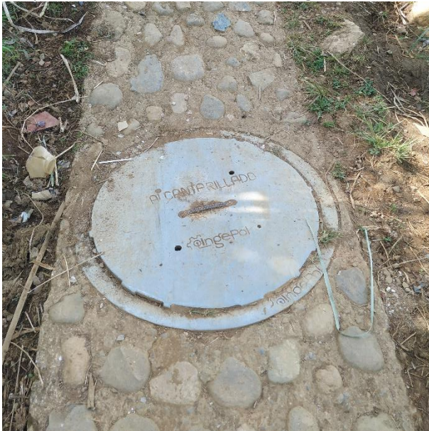
Figura 7-6. Fotografía red de alcantarillado
