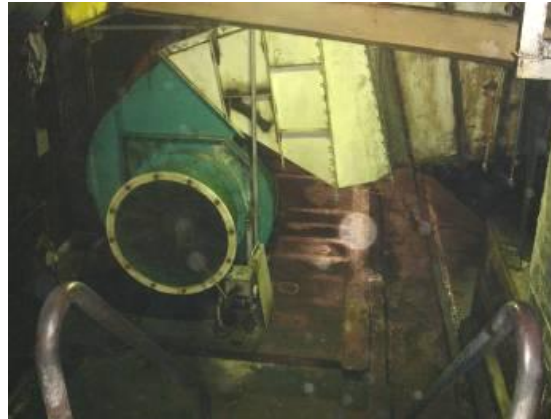
Figura 10. Ventilador enfriamiento aire refrigeración moldes
