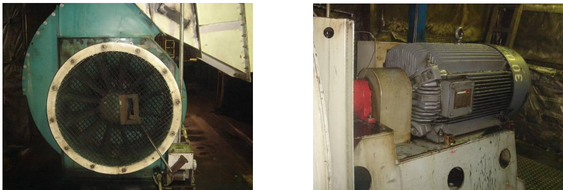
Figura 25. Conjunto motor eléctrico-ventilador centrífugo
