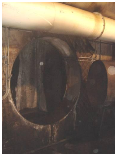
Figura 9. Ductos entradas de aire cuarto de ventiladores
