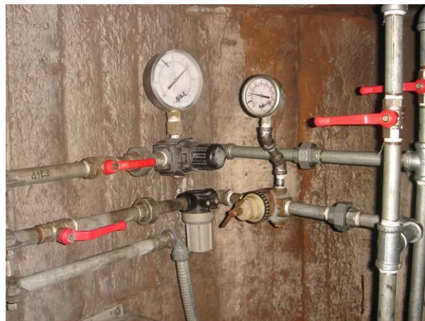
b. Detalle de los reguladores de presión de agua y aire comprimido
