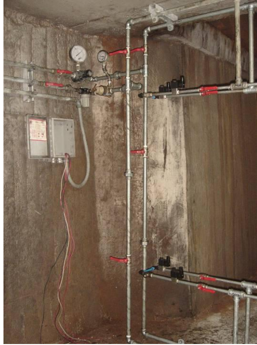
a. Vista general del sistema de aspersión
