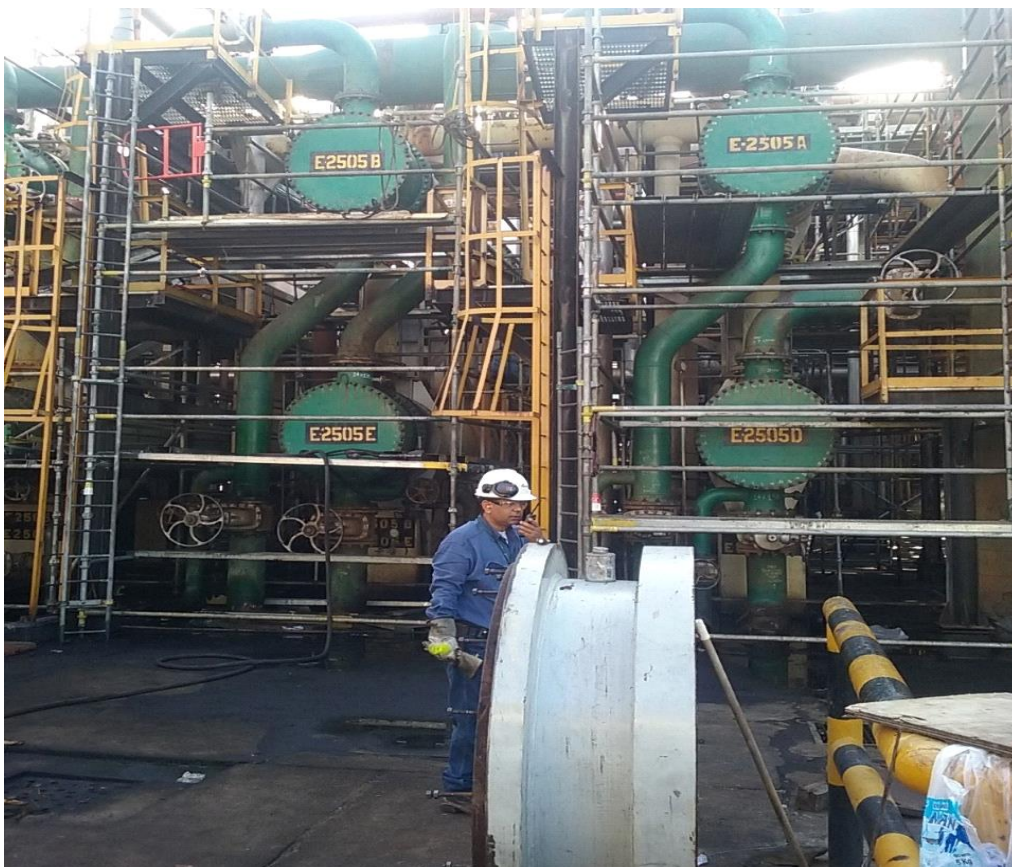
Ilustración 19. Intercambiadores de Calor
