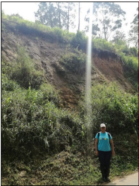
Foto 17. Deslizamiento Traslacional ubicado en la vía que conduce del parque Ecológico El Salado hasta las trucheras, a margen derecha de la Qda. La Ayurá.
