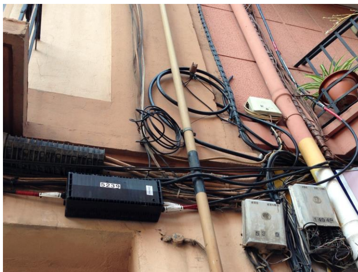
Gráfica 10. Tendido por fachada
