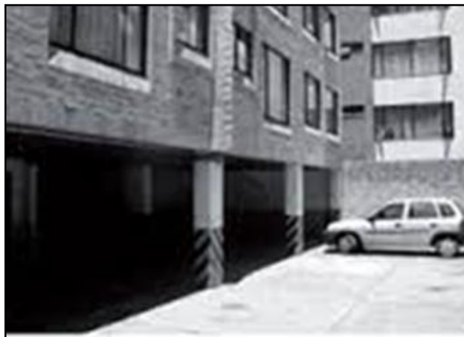
Fig. 52. Edificación construida que presenta un comportamiento de irregularidad por piso flexible.
