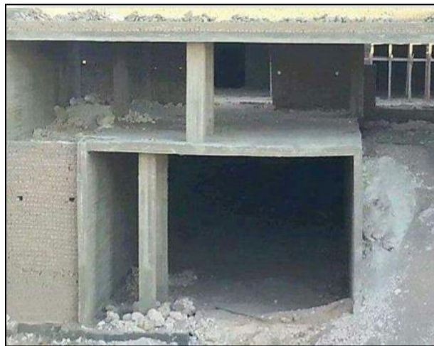
Fig. 59. Edificación en construcción con irregularidad por desplazamiento en el plano de acción.
