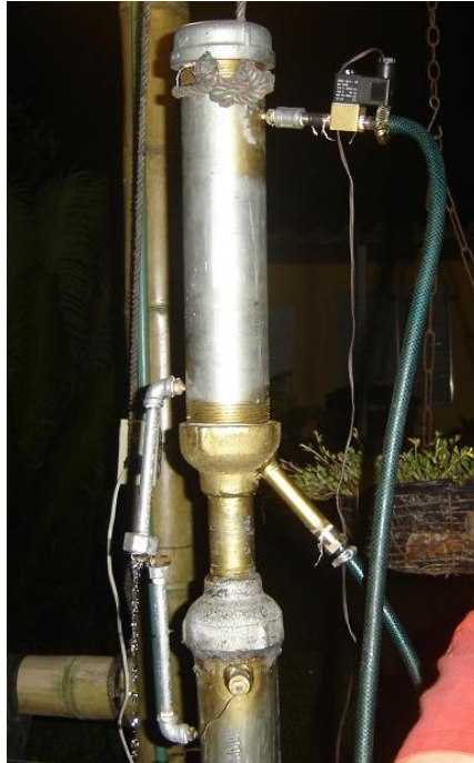
Figura 28. Destilador con control de temperatura automático averiado
