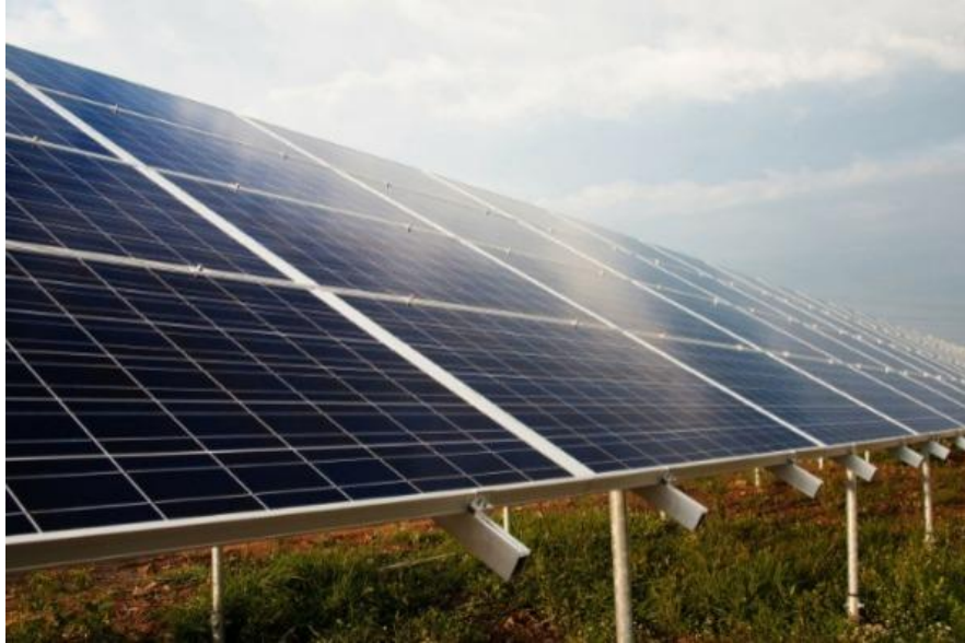
FIGURA 43. SISTEMA DE ENERGÍA SOLAR AUTÓNOMO.
