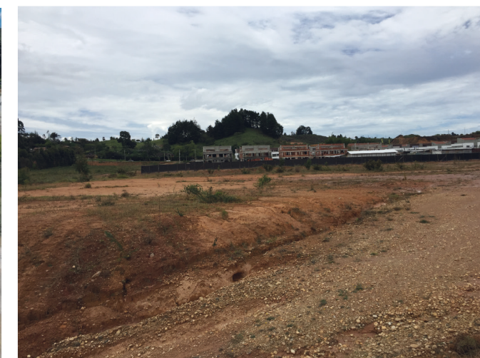
» Figura 114. Fotografías proceso de urbanización, etapa construcción. Fuente: Fotografía 1: recuperada de http://www.lotuscasas.com/avances_obra_lotus_casas_rionegro_antioquia.php . Fotografía 2: elaboración propia.
