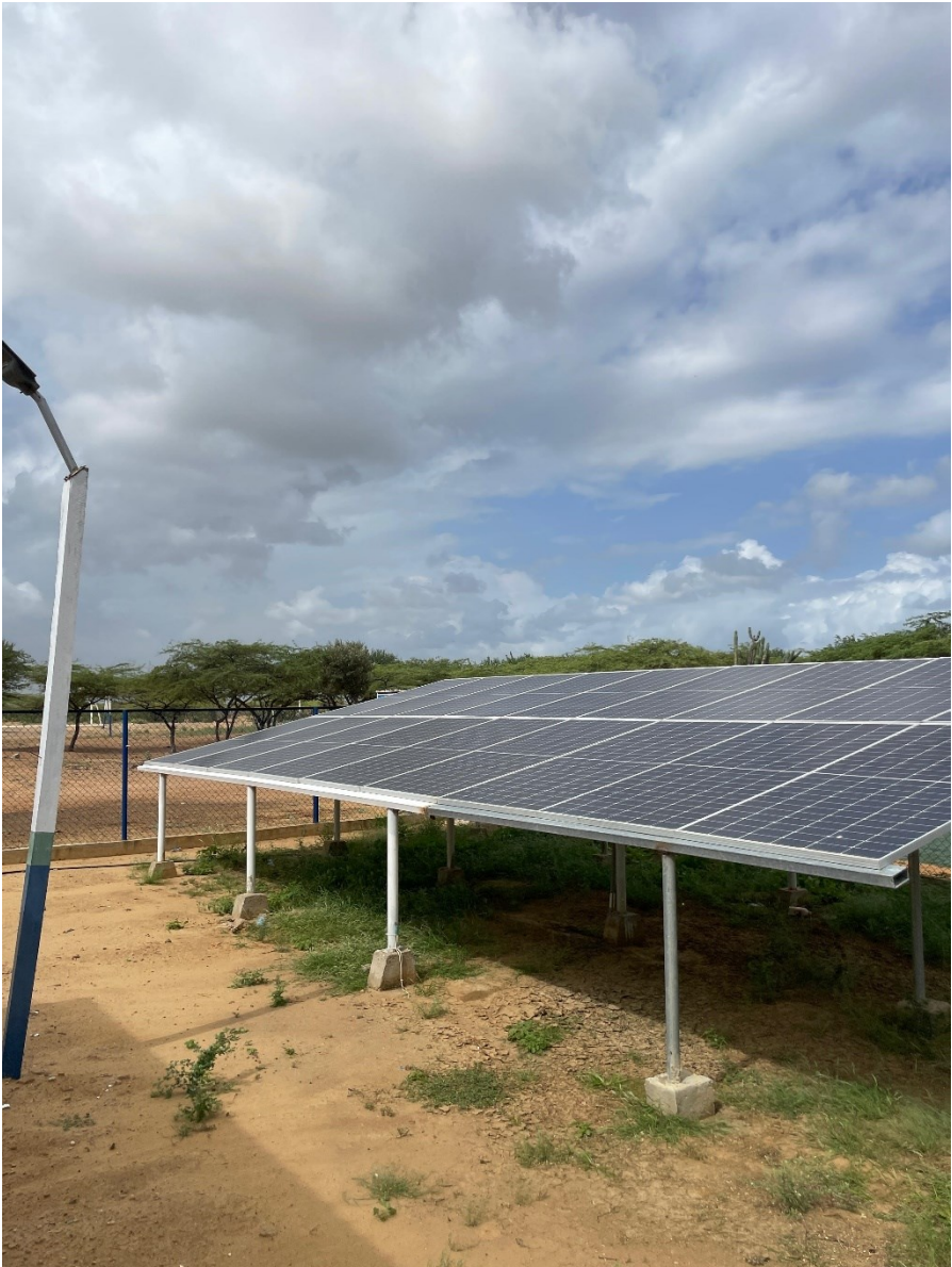
FOTO A 5. SISTEMA FOTOVOLTAICO
