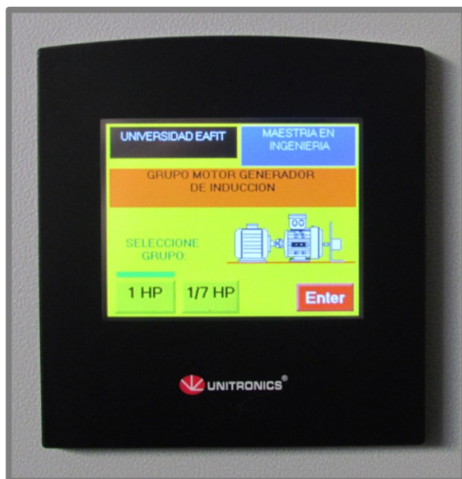
Figura 7.2. Vista Pantalla en el HMI del PLC con el grupo \text{M} - \text{G} .
