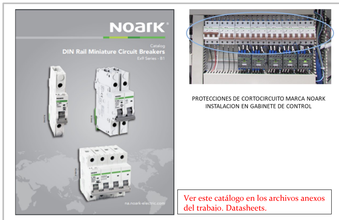
Figura 16.12. Interruptores eléctricos trifásicos utilizados en las protecciones de cortocircuito del tablero de control.
