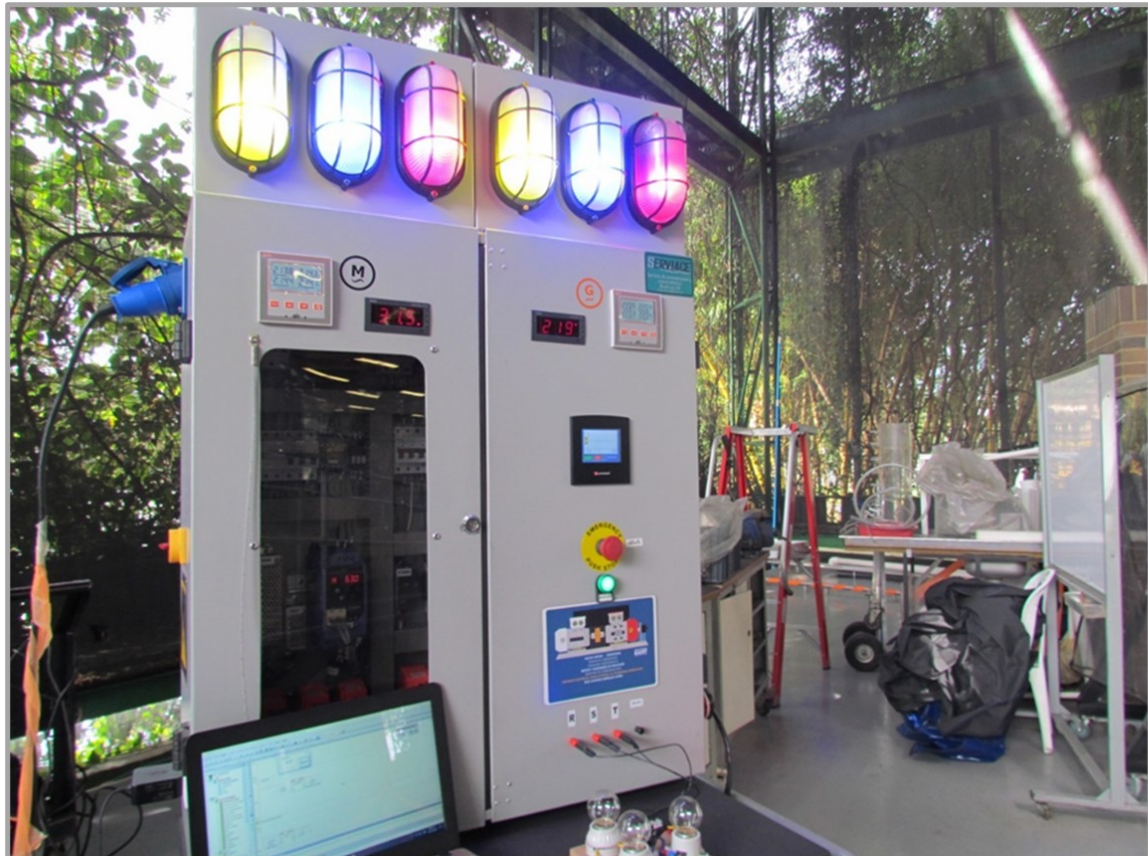
Figura 11.11. Banco de trabajo. Se observan en la parte superior los dos grupos de cargas resistivas ( bombillas de 7 W cada una) en configuración en \lambda . Abajo se observa la salida RST N para conectar por allí varias cargas las cuales se pueden comandar a través del pantallazo Otras cargas en el HMI del PLC.
