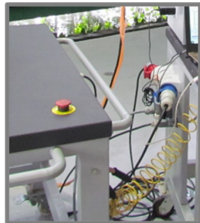
Parada de emergencia en la mesa de pruebas del grupo motor generador en estudio. Fácilmente accesible al usuario.
