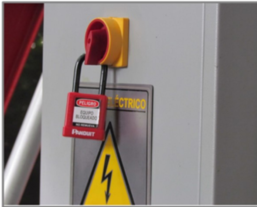
Blindaje del sistema. Candado de seguridad en el desconectador principal
