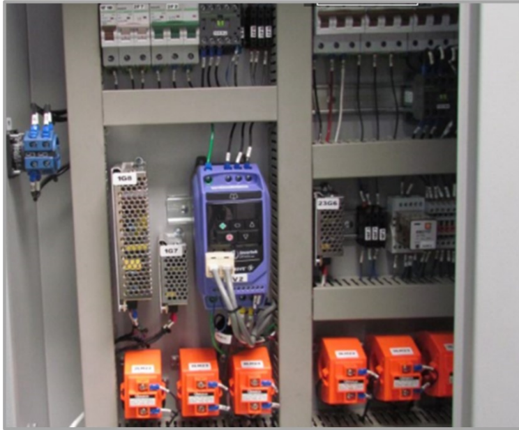
Figura 11.12. VDF que asiste al Motor asíncrono del banco. Es de una potencia de 1,2 HP. Su display permite observar la frecuencia de trabajo con el equipo trabajando . También es posible observar otras variables tales como Voltaje de salida y de entrada, Corriente de salida, potencia entregada, etc.
