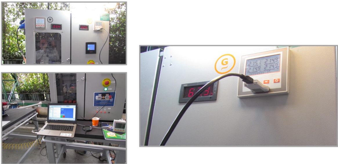
Figura 6.17. Vista de la llave USB usada para comunicar el software xPRESS marca LOVATO desde una PC con los medidores de variables eléctricas DMG610 marca LOVATO. Esta llave en conjunto con el software facilitan la parametrización de los equipos (uno para \text{M} y otro para \text{G} ) y además cuenta con la monitorización en línea del equipo que se desee analizar en mas detalle en los ensayos.
