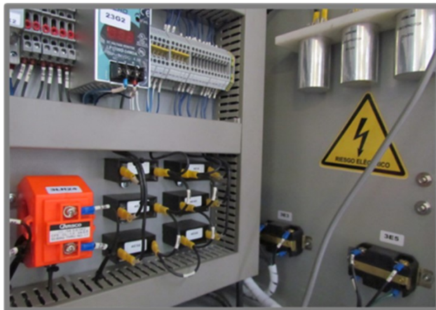
Señalización interna del tablero para indicar peligro de riesgo eléctrico en los condensadores de carga del banco.
