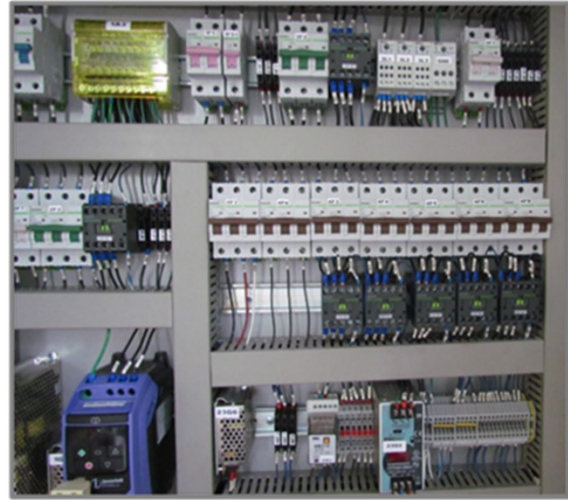
Protecciones eléctricas a los circuitos y elementos activos del banco de pruebas.
