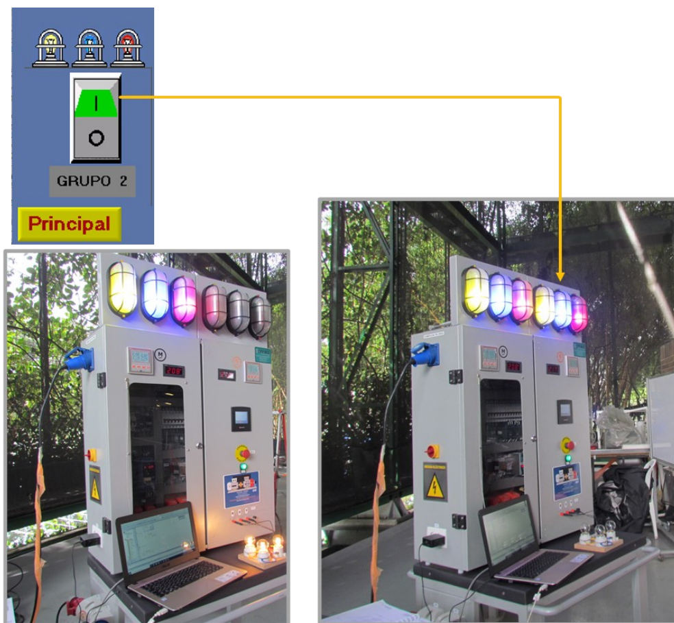
Figura 9.44. Vista del grupo de bombillas LED adicionales que se pueden comandar desde el Pantallazo Otras cargas. Las fotos muestran el grupo de bombillas adicionales que posee el tablero de control en su parte superior derecha, apagadas inicialmente y luego encendidas. Están conectadas en configuración \lambda trifásica.
