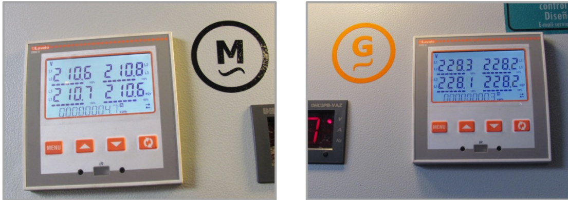
Figura 10.1. Fotografías de los medidores de variables eléctricas utilizados en el banco de trabajo. Marca LOVATO. Modelo DMG610
