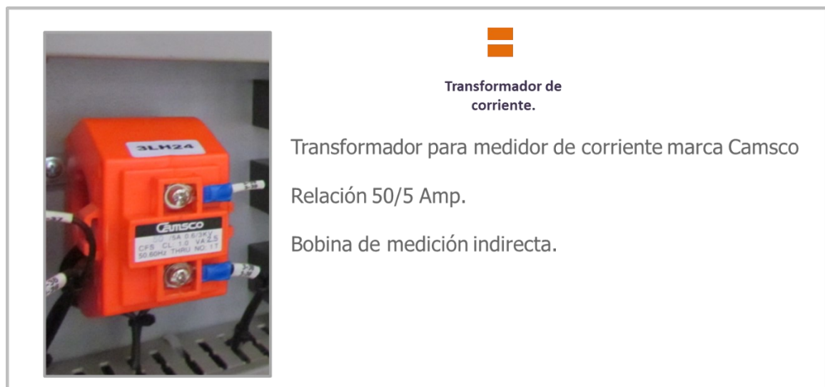
Figura 10.4. TC's marca CAMSCO relación 50/5 A, para adecuar señales de corriente al DMG610.
