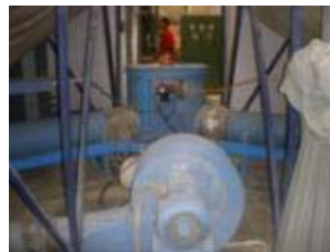
Figura 9 Ducto de alimentación
