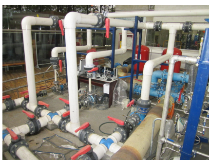
Figura 1.8: Banco de Turbomáquinas.
