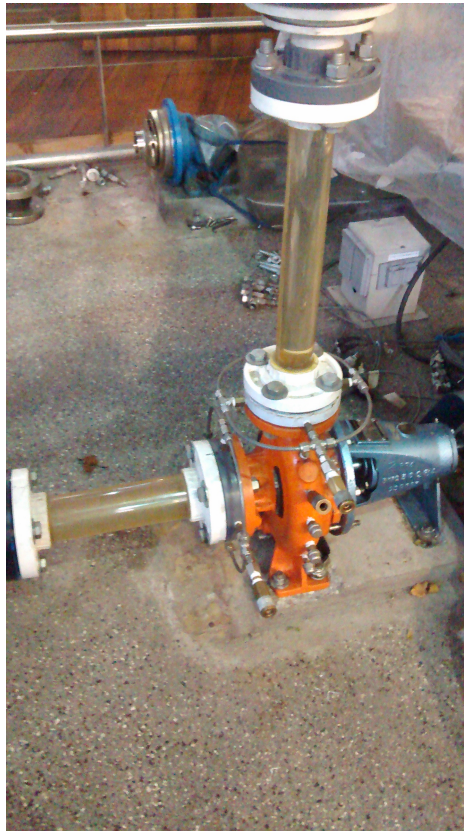
Figura 6.9: Tuberías en Acrílico.
