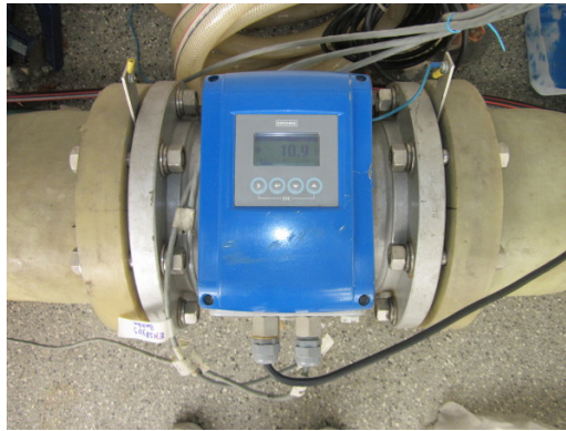
Figura 3.7: Medidor de Caudal.
