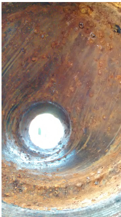
Figura 2.11: Estado de la tubería de succión desmontada.
