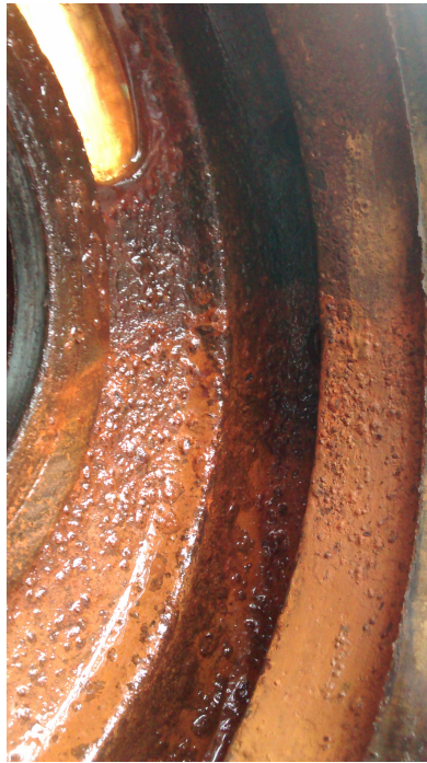
Figura 6.2: Corrosión de la voluta.
