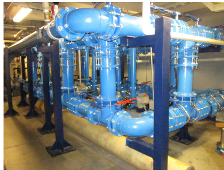
(b) Sistema de Tuberías.
