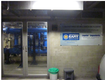
(a) Entrada Cuarto Bombas.
