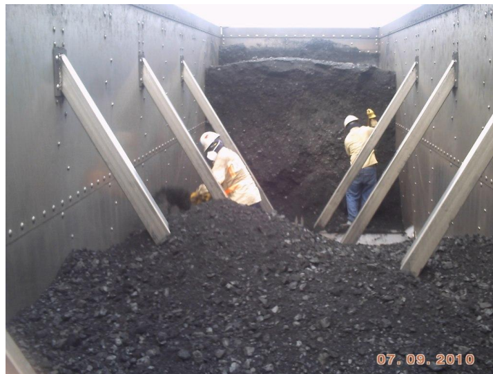
Figura 2. Desplazamiento del carbón a la parte media del vagón
