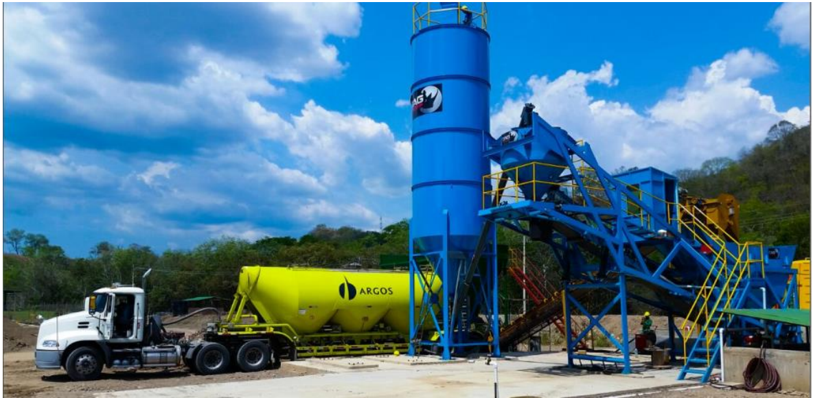
Figura 21. Planta de concreto premezclado
