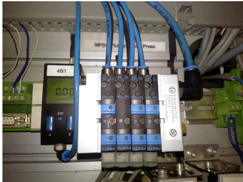
Ilustración 32 - Válvulas de presión y mangueras
