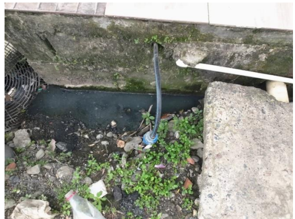
Figura 47. Conexión de acueducto en medio de aguas residuales. Fotografía: Diego David Sierra Gutiérrez, 2025.
