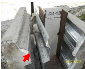
Figura 16. Probeta #1. Falla del concreto. Con una barra se retiró la losa para observar el espigo.
