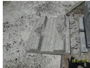
Figura 22. Probeta #3. C Superficie de falla en el concreto.
