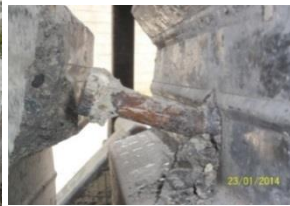
Figura 17. Probeta #1. Se observa que el espigo con cabeza giró, lo cual es indicio que alcanzó a fluir.
