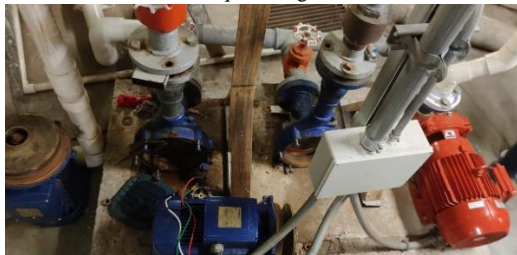
Figura 2. Bombas SRAL bloque de ingenierías Universidad EAFIT.
