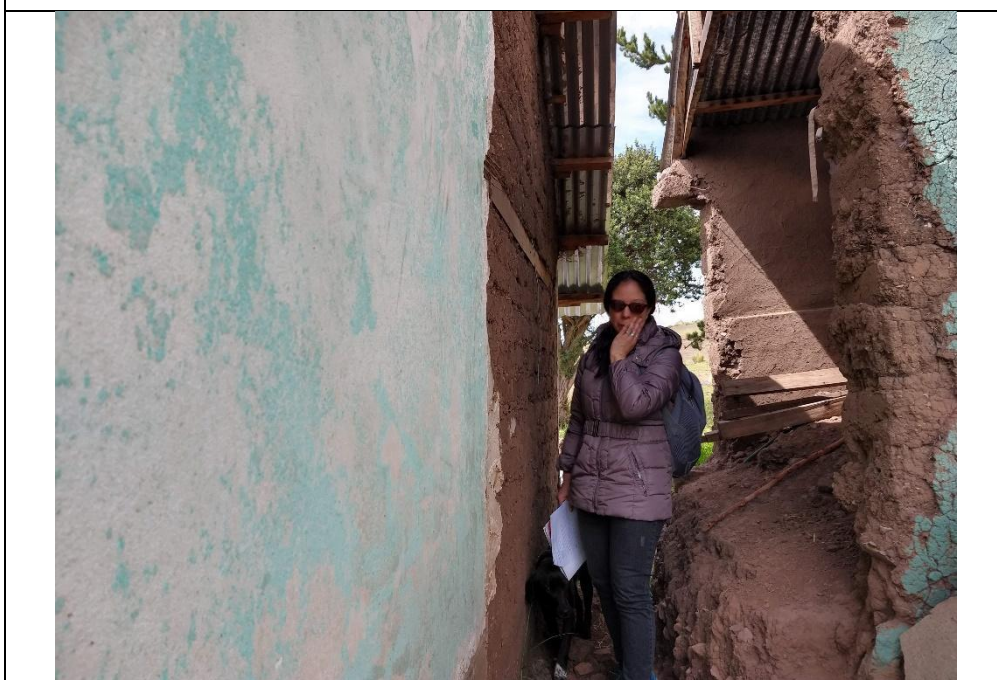
Falta de Tarrajeo
