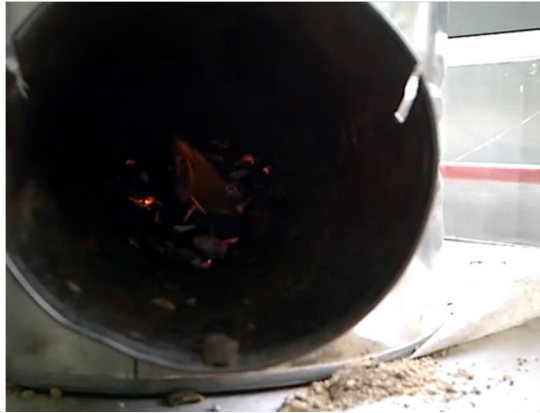
Ilustración 35. Quema de cáscara en la cámara de combustión
