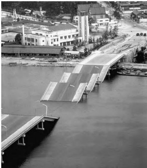
Ilustración 3. Colapso del Puente Showa por esparcimiento lateral - Terremoto de Niigata (1964)
