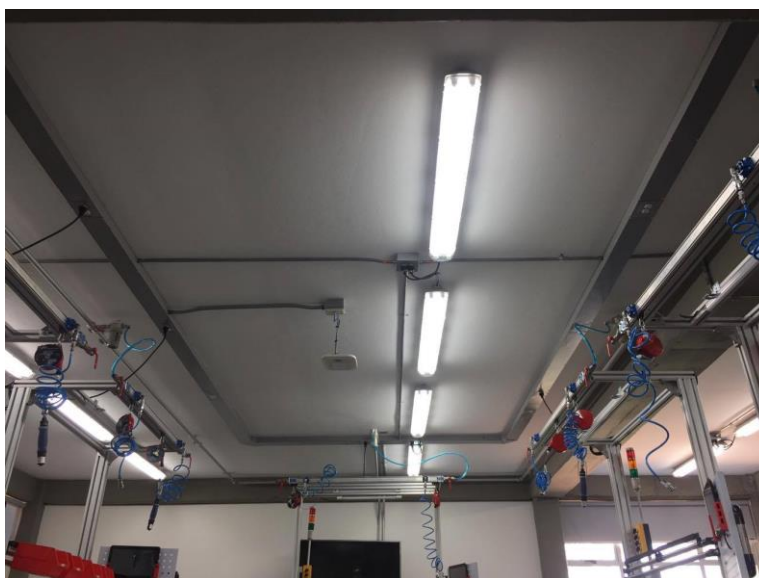
Ilustración 26. Redes de aire, iluminación, eléctrica y datos.
