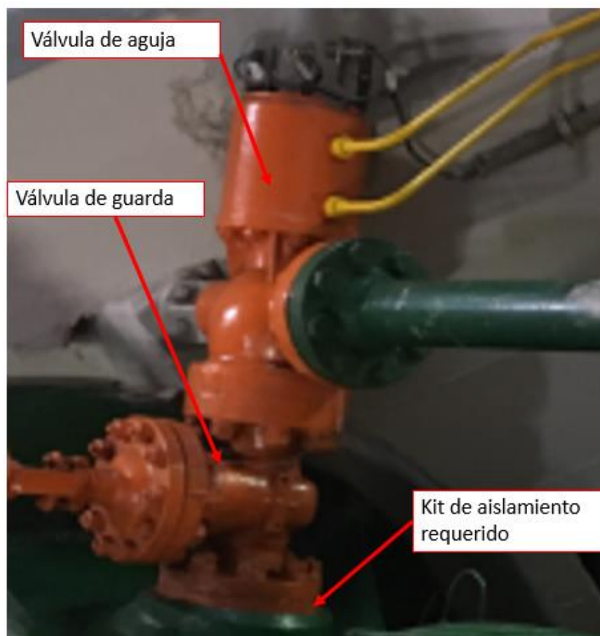
Figura 35. Válvulas presentes en sistema By-Pass
