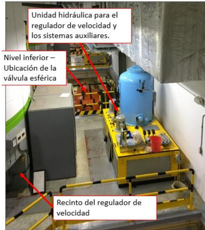
Figura 14. Unidad hidráulica vinculada a unidad de generación de la Central Hidroeléctrica Guatapé
