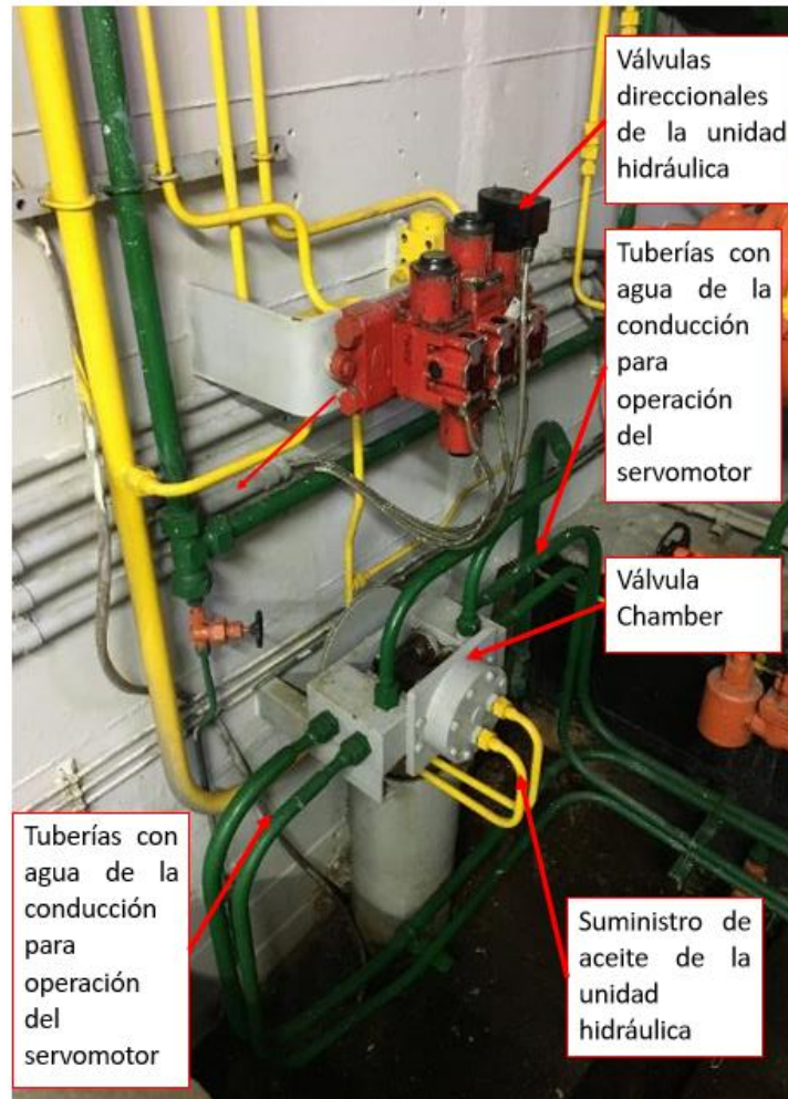
Figura 15. Válvula Chamber Central hidroeléctrica Guatapé
