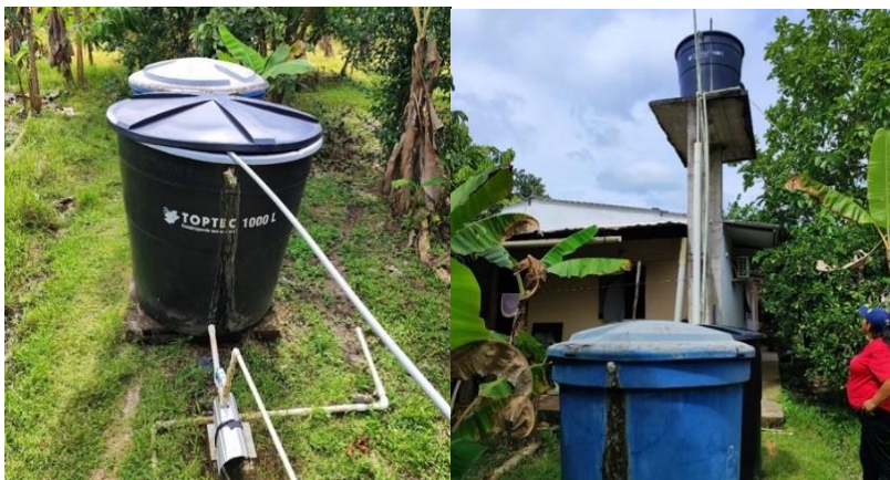
Figura 12. Sistema casero de tratamiento y distribución de agua
