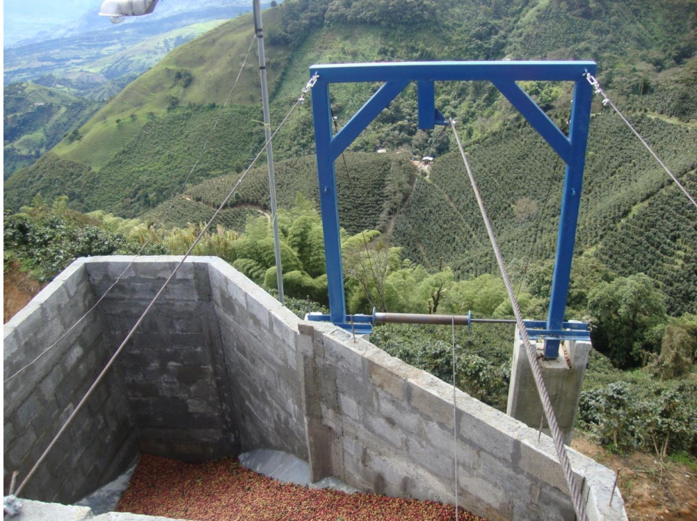
Figura 46. Torre o apoyo del cable.
