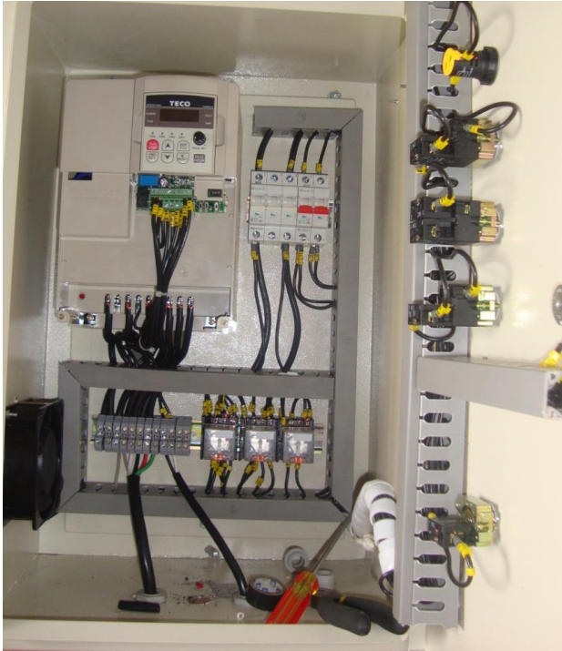
Figura 45. Variador de velocidad y demás componentes del tablero de control.
