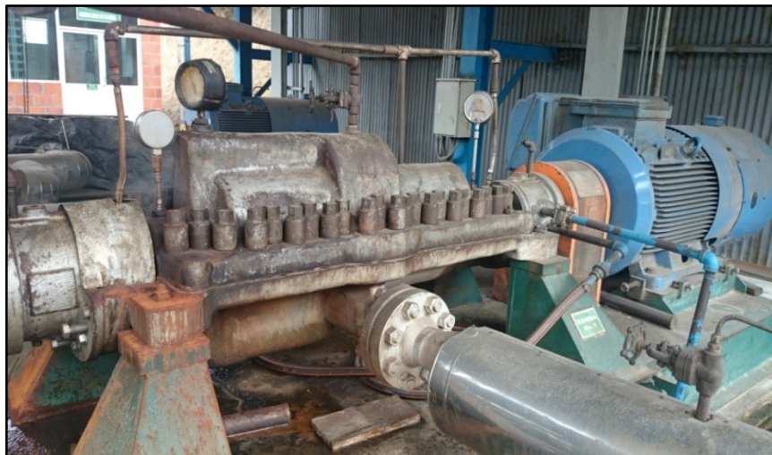
Ilustración 6 - Estación de bombeo agua de alimentación a caldera
