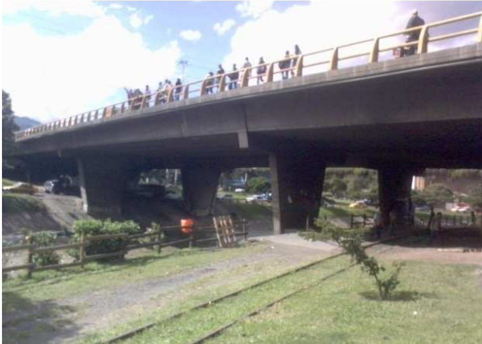
Figura 6.16. Foto del perfil del puente de la avenida San Juan sobre el Río Medellín
