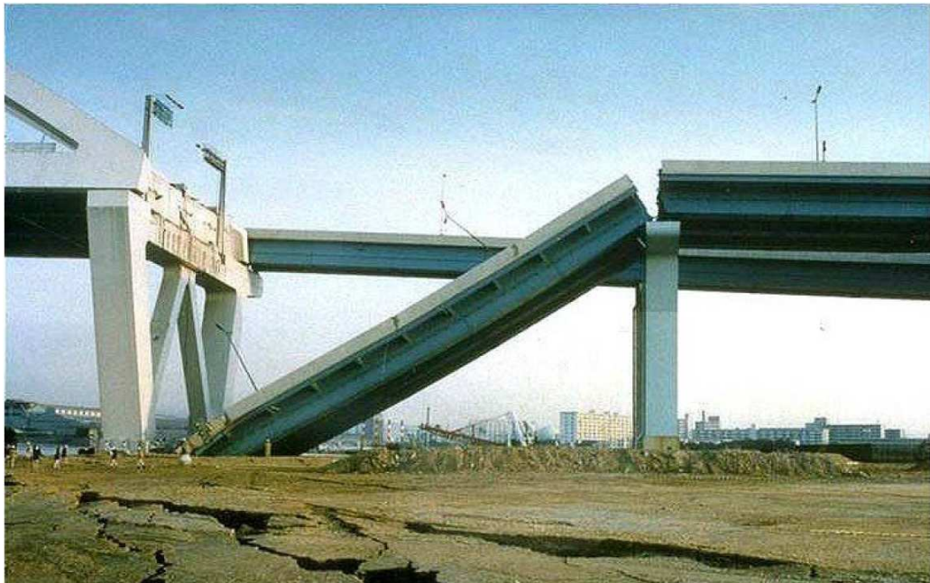
Figura 4.6. Colapso del tablero del puente por pérdida de asiento las vigas por causa de un evento sísmico (Mitchell, 2006)
