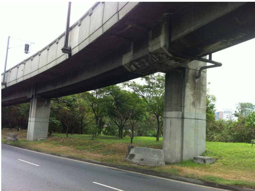
Figura 4.2. Subestructura de viaducto que presenta una excentricidad respecto a su apoyo
