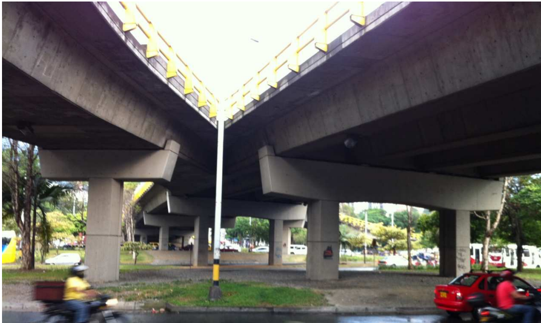
Figura 4.14. Subestructuras de una sola columna y un pórtico de dos columnas, respectivamente, en una misma estructura.
