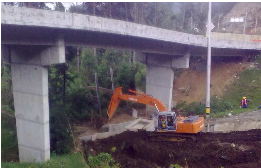
Figura 4.5. Rotación de subestructura por problema de estabilidad bajo la cimentación
