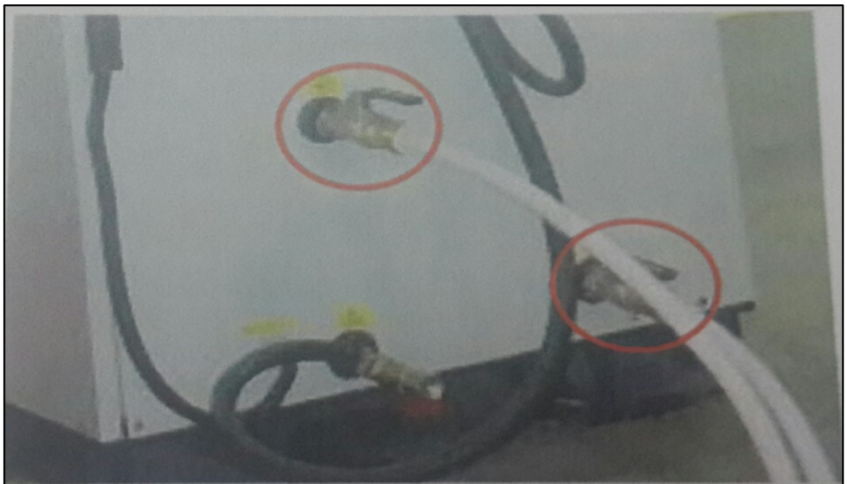
Ilustración 25 - Llaves de paso del refrigerador externo
