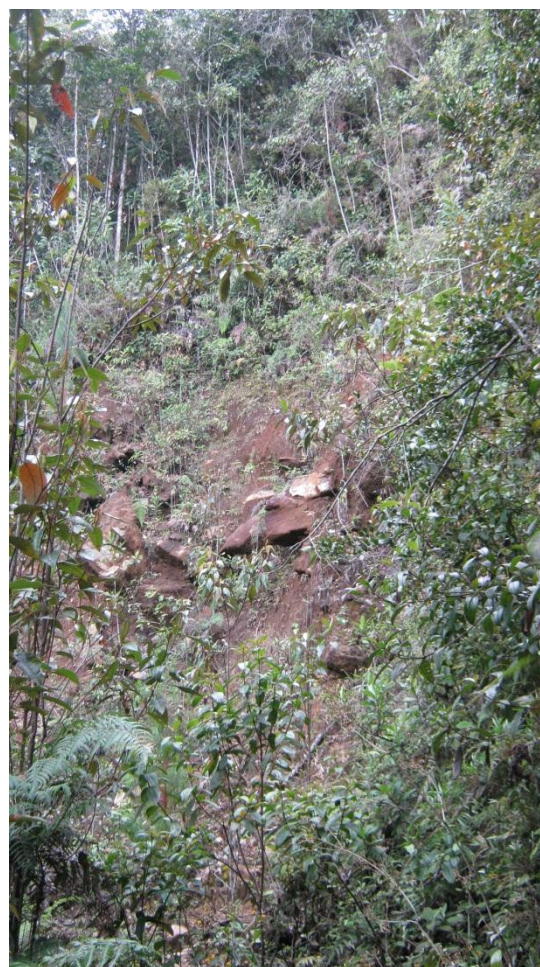
Figura 68. Desgarre superficial, ubicado en el escarpe conformado por el corredor de falla del Neis Milonítico de Sajonia, denominado falla la Acuarela.
