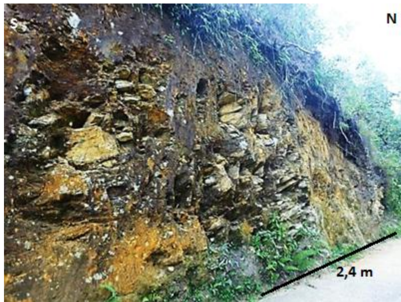
Figura 25. Fotografía de flujo de escombros, localizado en el sector de Chorro Clarín, sobre la margen izquierda de la vía que conduce de la vereda Mazo al sector del Tambo.
