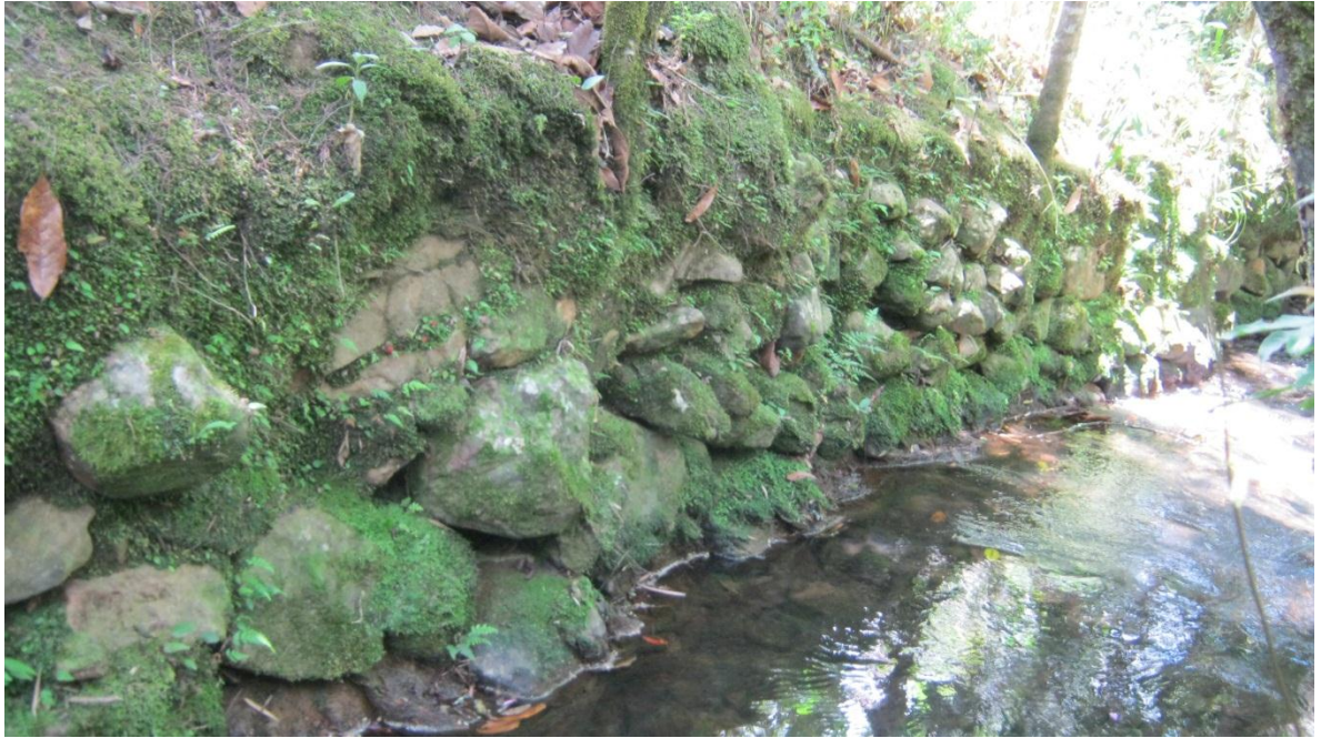
Figura 85. Quebrada El Rosario, con muro artificial en roca construido durante la colonia, a la altura del núcleo de Comfama.
