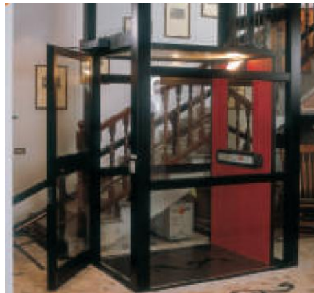
Figura 13: Estructura Vimec instalada en el interior de una casa.
