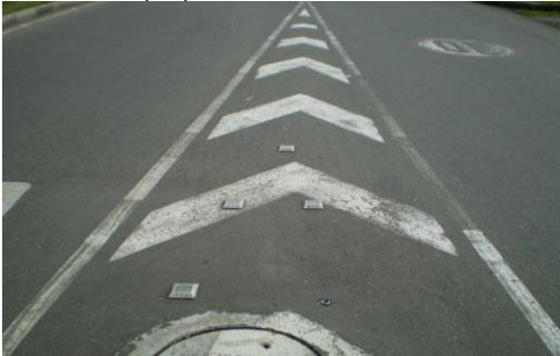
Foto 73. Perdidas de tachas reflectivas. Fuente: elaboración propia.
