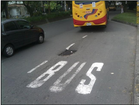
Foto 68. Sumidero mal ubicado. Fuente: elaboración propia.
