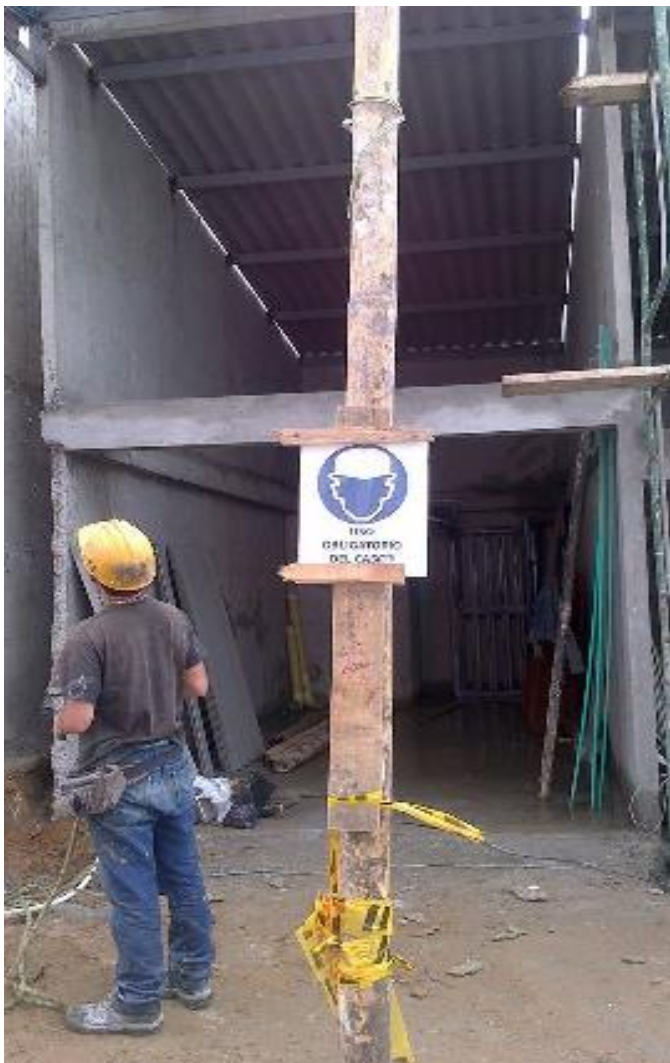
Figura 39. Letrero con medida de protección E4O2
