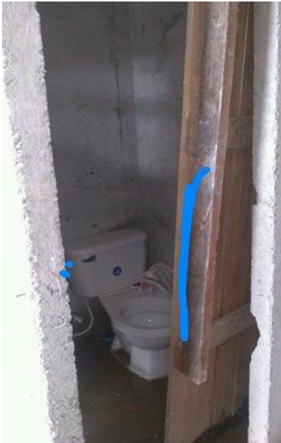
Figura 38. Servicio sanitario obra E4O2
