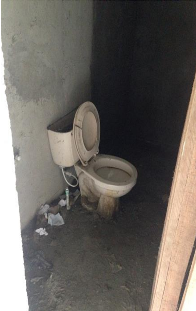
Figura 34. Servicio sanitario obra E4O1
