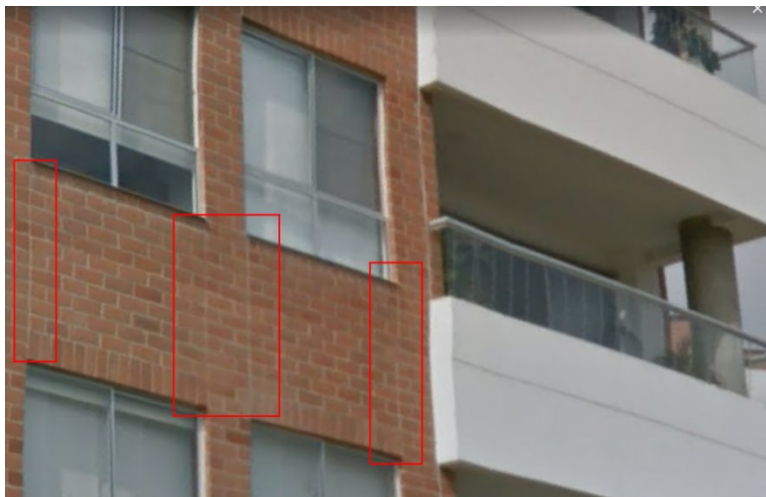
Fig 21. Edificación de pórtico de concreto resistente a momentos. Resaltado en rojo las juntas de dilatación, © Google 2022.
