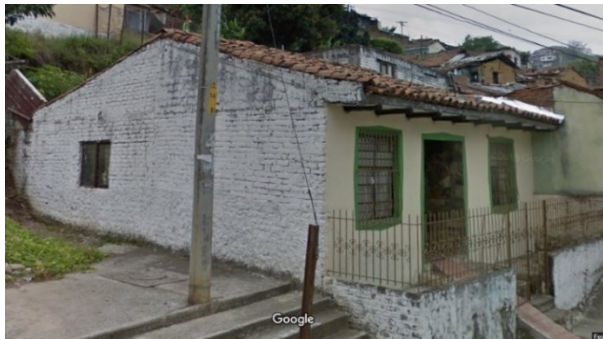
Fig 19. Construcción de muros en adobe sin ductilidad presente en la ciudad de Santiago de Cali, © Google 2021.
