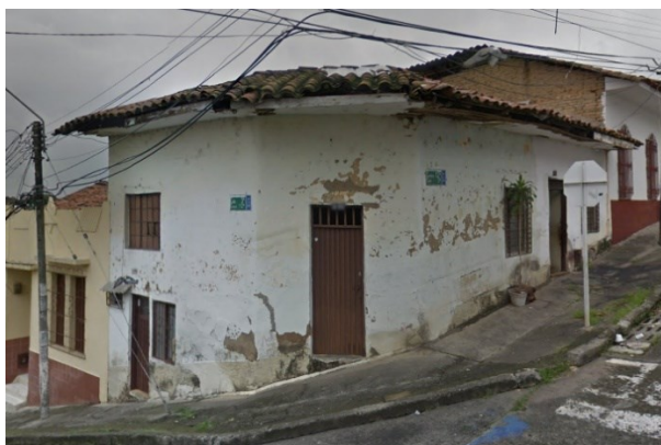
Fig 20. Construcción de muros de tapia sin ductilidad presente en la ciudad de Santiago de Cali, © Google 2022.
