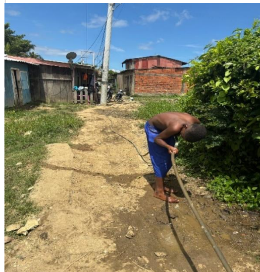
Figura. 18 Conexiones de mangueras para suministro de agua.
