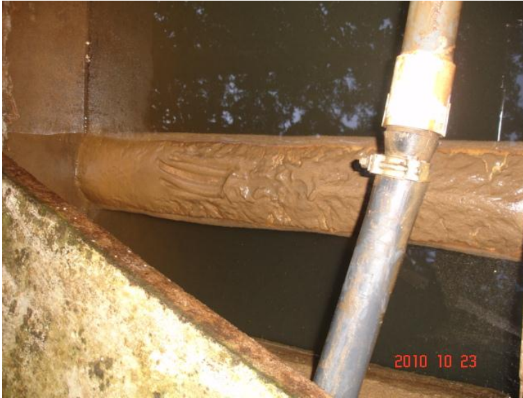
Figura 53. Estructuras antes de arreglar los pequeños problemas encontrados al momento de la visita.
