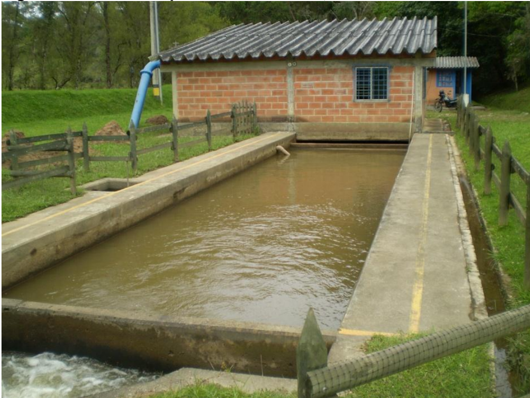
Figura 36. Bocatoma quebrada Barbacoas, Marinilla.
