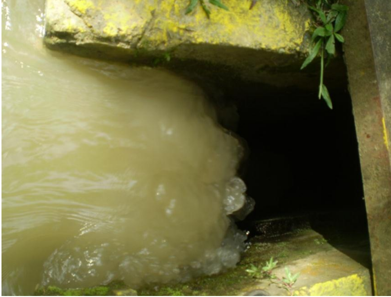
Figura 30. Canal de excesos conduce de nuevo a la fuente.
