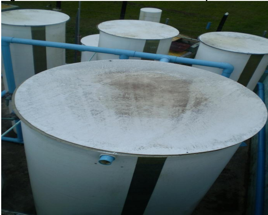
Figura 49. Planta de tratamiento vereda El Capiro.
