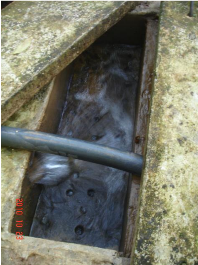
Figura 54. Estructuras después de arreglar los pequeños problemas encontrados al momento de la visita.
