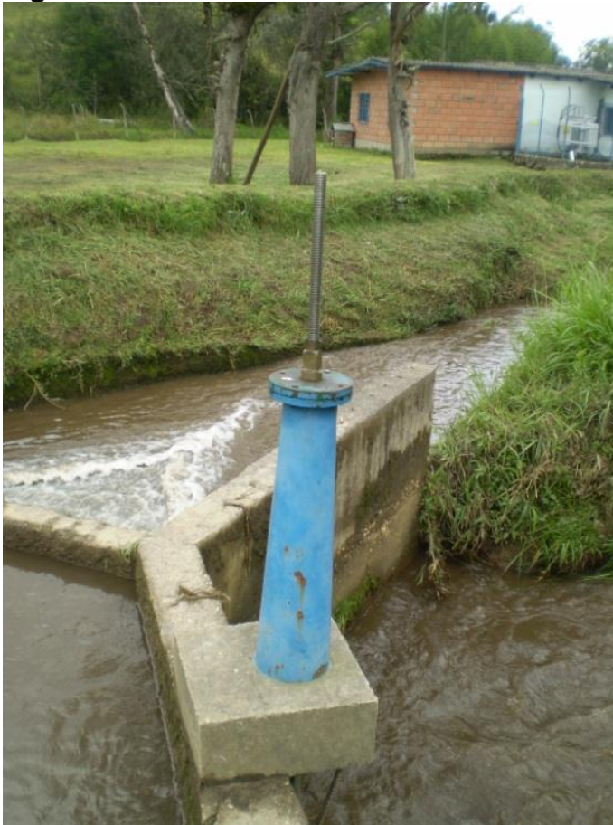
Figura 44. Jarillones de limo arcilloso en bocatoma quebrada La Bolsa.
