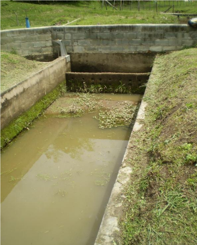
Figura 41. Desarenador, quebrada La Bolsa.
