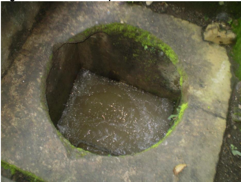
Figura 22. Cámara de aquietamiento No. 1.
