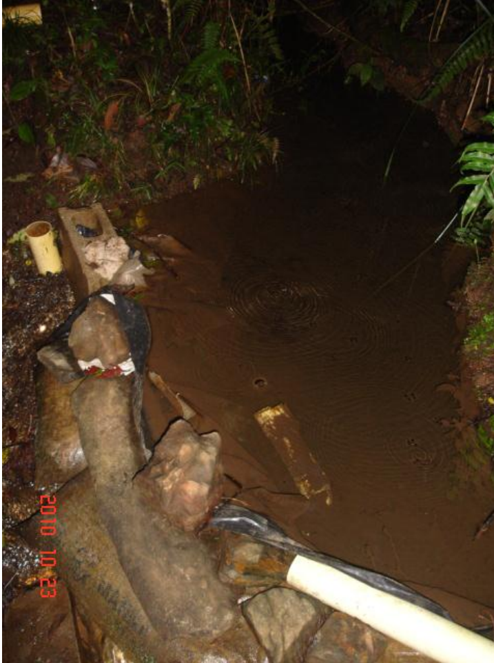
Figura 58. Bocatoma artesanal 2, construida para solucionar los problemas de desabastecimiento de aguas en el sistema.
