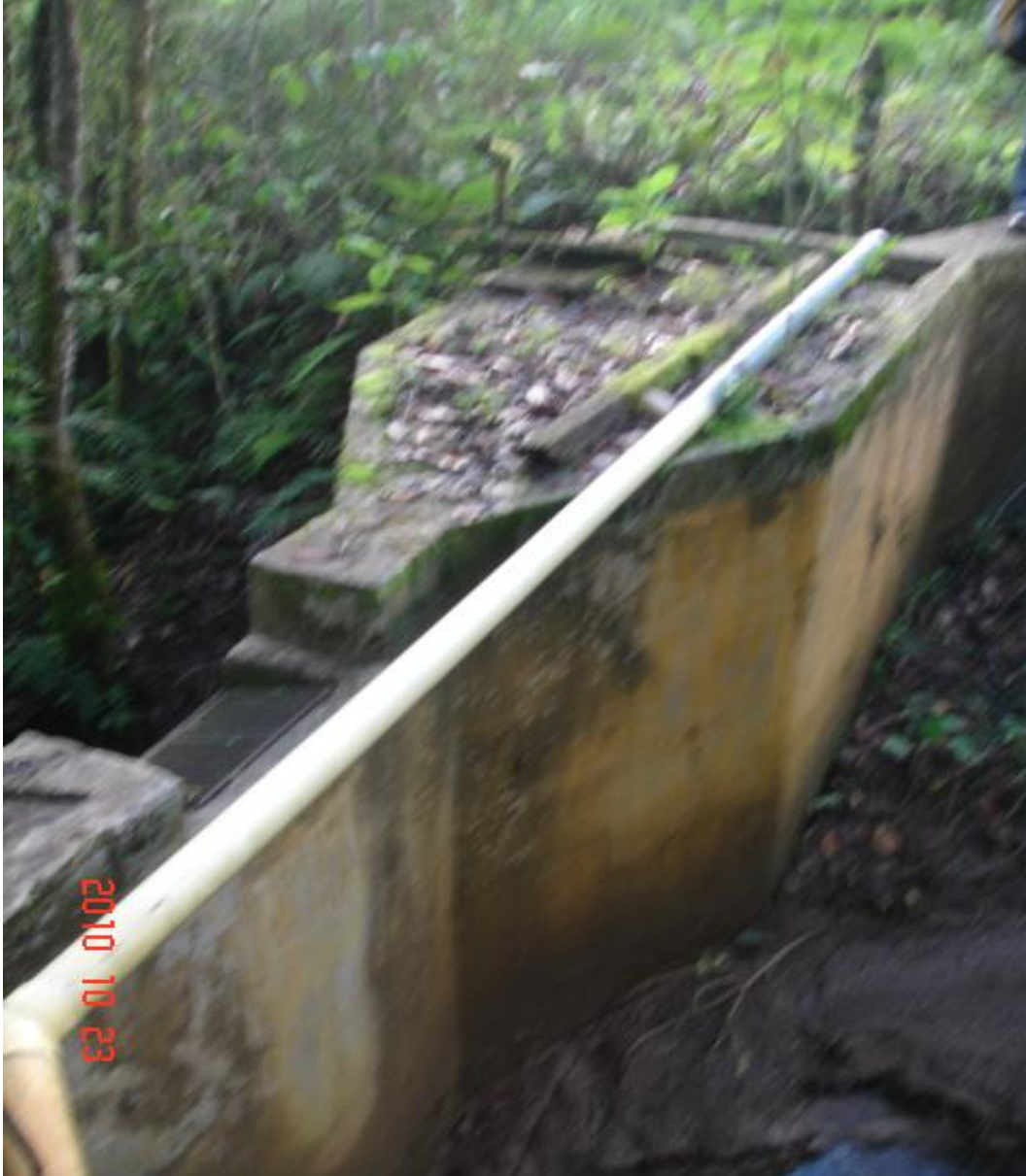
Figura 51. Bocatoma 2, nunca entró en funcionamiento por filtraciones.
