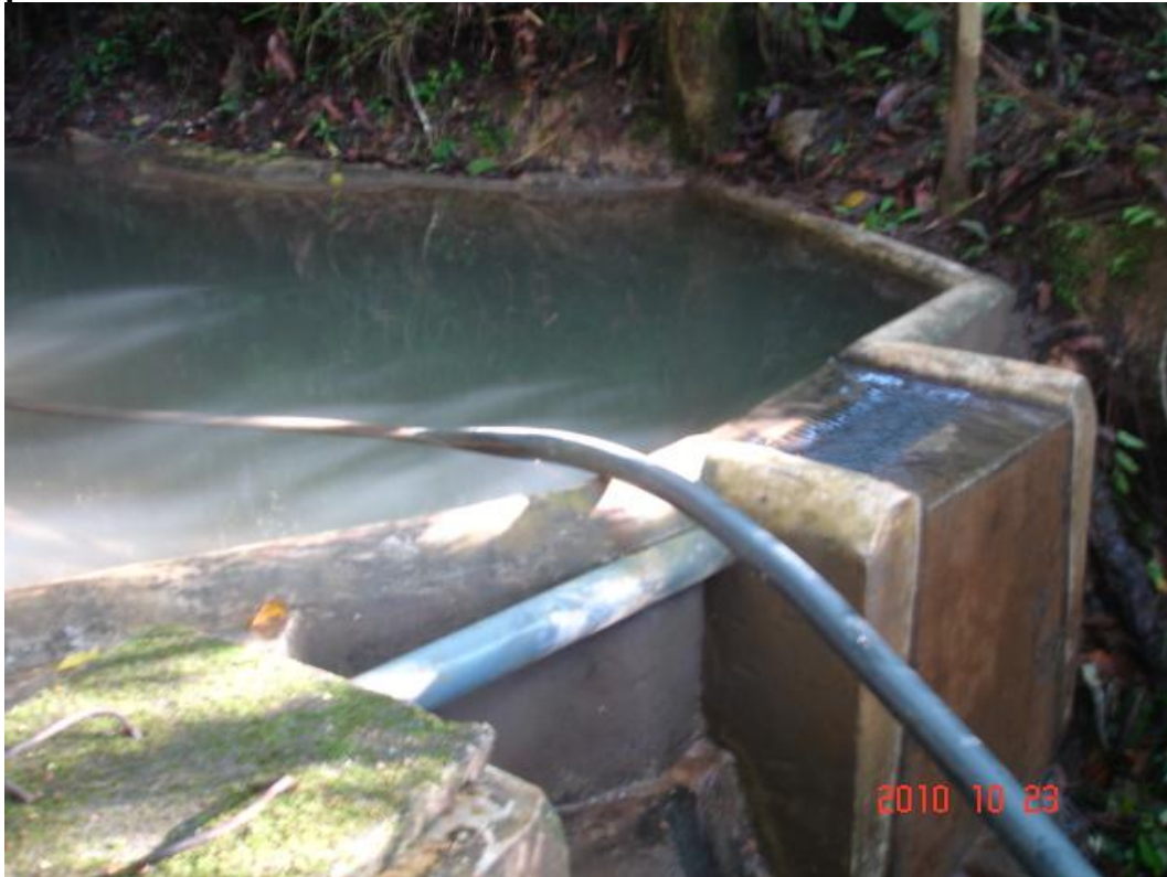
Figura 52. Bocatoma 3, bocatoma que es la única que funciona permanentemente.
