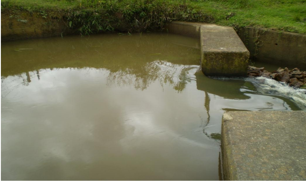
Figura 38. Rejilla de fondo captación quebrada Barbacoas.
