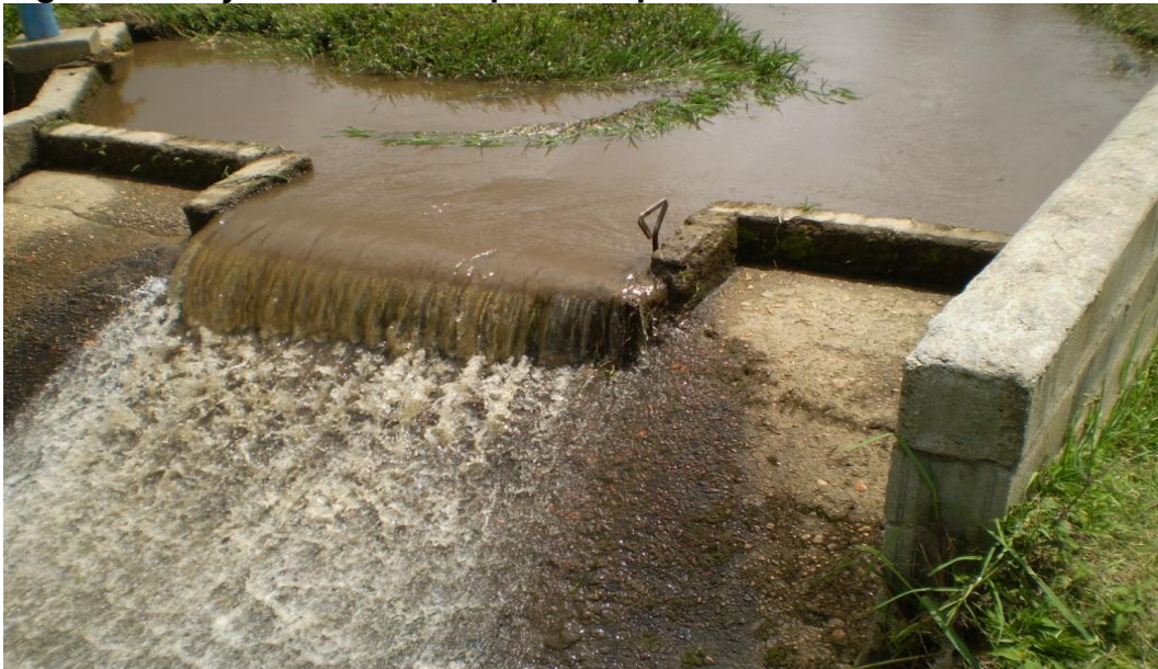
Figura 39. Rejilla de fondo captación quebrada La Bolsa.
