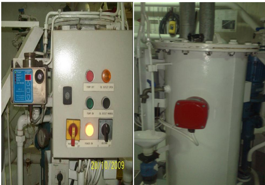
Ilustración 37 a) Control de separador, b) Tanque de separación de sentinas
