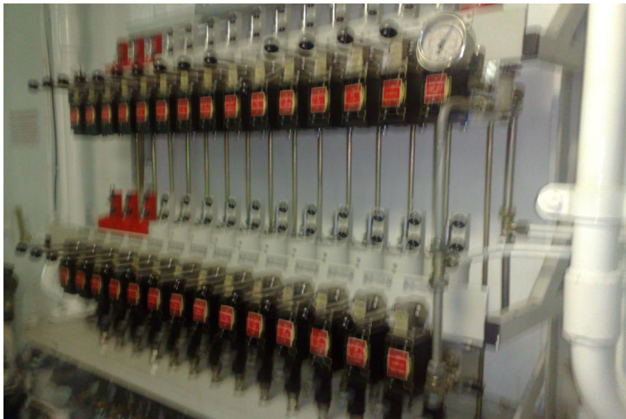
Ilustración 31 Sistema de válvulas de lastre
