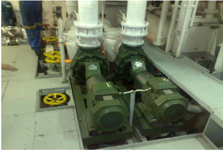
Ilustración 30 Bombas de lastre
