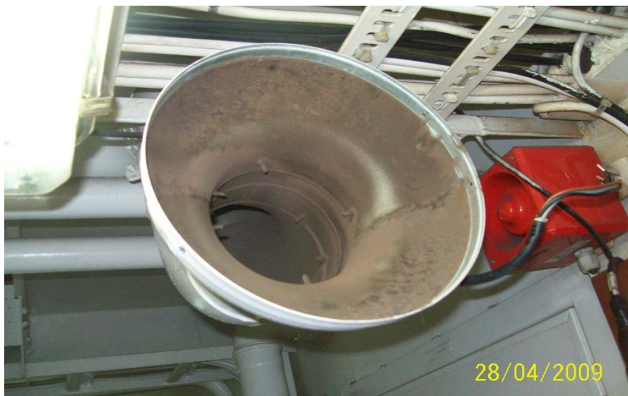
Ilustración 39 Extractores de aires
