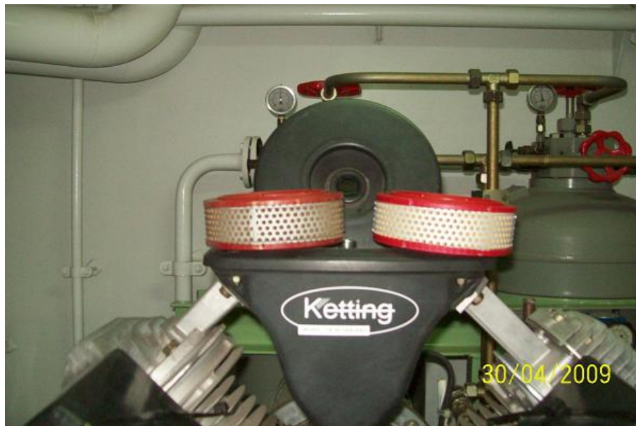
Ilustración 26 Compresor de arranque y botellas de aire
