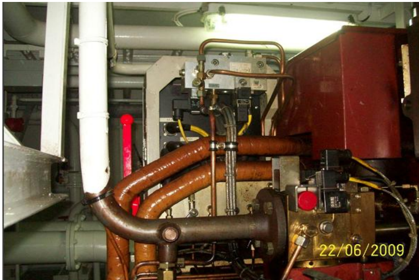
Ilustración 41 Sistemas de extracción de aires de bodega
