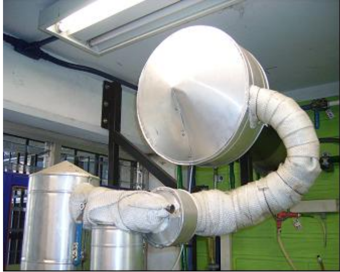
Figura 23 Sistema de bypass de la torre de rectificación del SRB utilizado en la elaboración los ensayos preliminares antes del cambio
