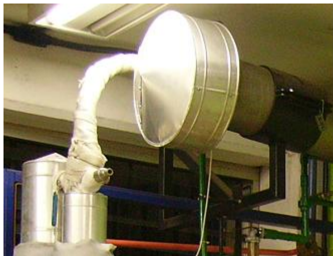
Figura 24 Sistema de bypass de la torre de rectificación del SRB después del cambio
